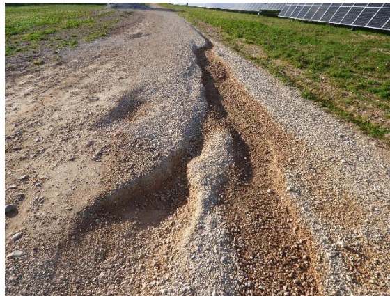
Imagen 2. Procesos erosivos en uno de los caminos interiores de la planta fotovoltaica
