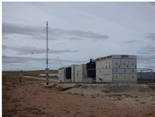
Imagen 7. Periódicamente el promotor revisa las cintas de plástico instaladas en los tensores de las torres anemométricas cuya finalidad es incrementar la visibilidad de los mismos por parte de la avifauna
