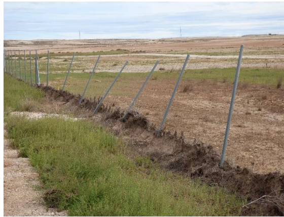
Imagen 1. Tramo del vallado perimetral afectado por las lluvias torrenciales registradas durante la época estival
