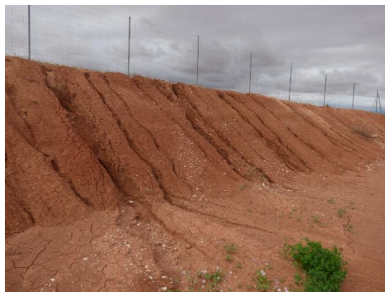
Imagen 3. Procesos erosivos en el talud situado al Sur de la planta fotovoltaica de "Híjar I"
