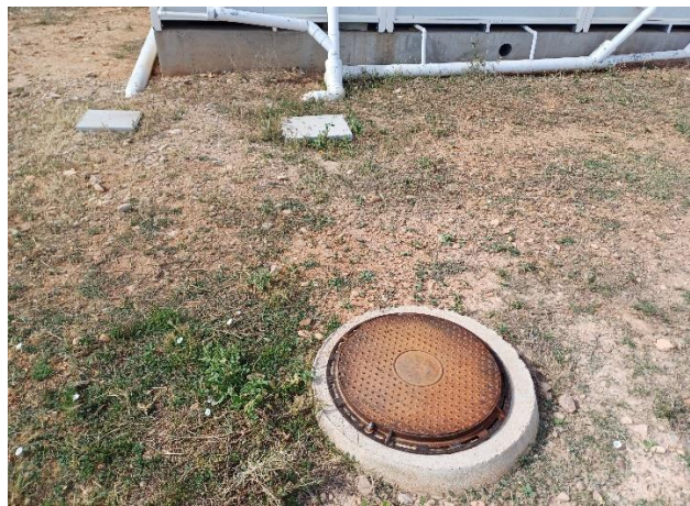
Imagen 2. Tuberías de salida de las aguas residuales del edificio de O&M y tapa de acceso al depósito estanco, sin evidencias de desbordamientos
