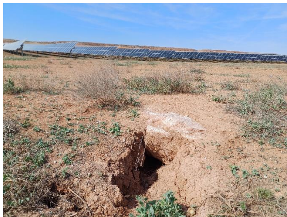
Imagen 15. Madriguera en el interior de una de las plantas fotovoltaicas
