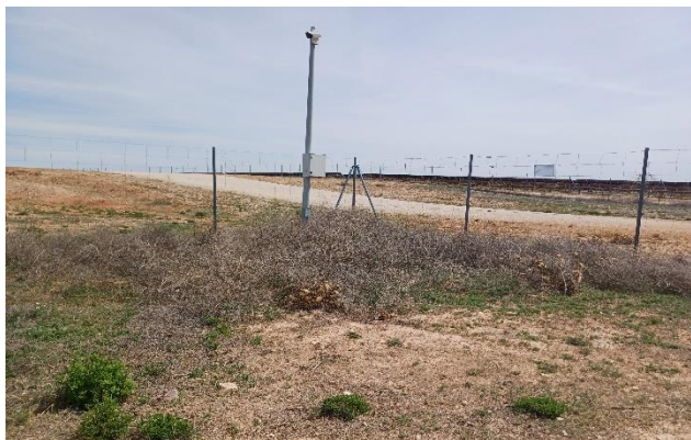
Imagen 6. Acumulación de capitanas en una de las esquinas del vallado perimetral
