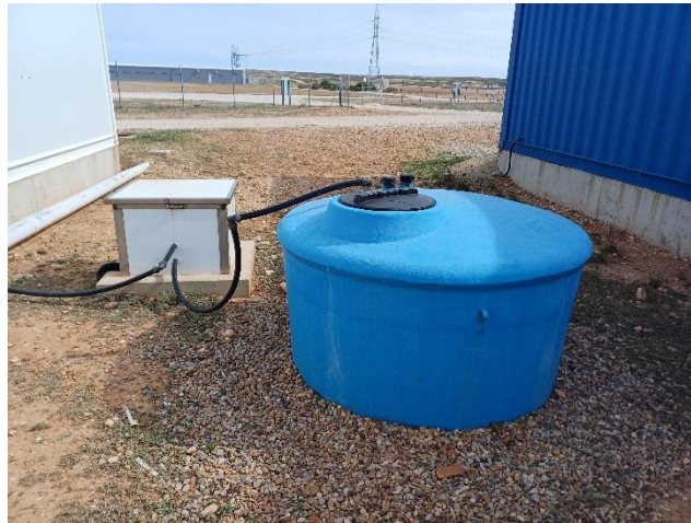
Imagen 3. Depósito para el almacenamiento de agua con destino a los aseos existentes en el edificio de O&M
