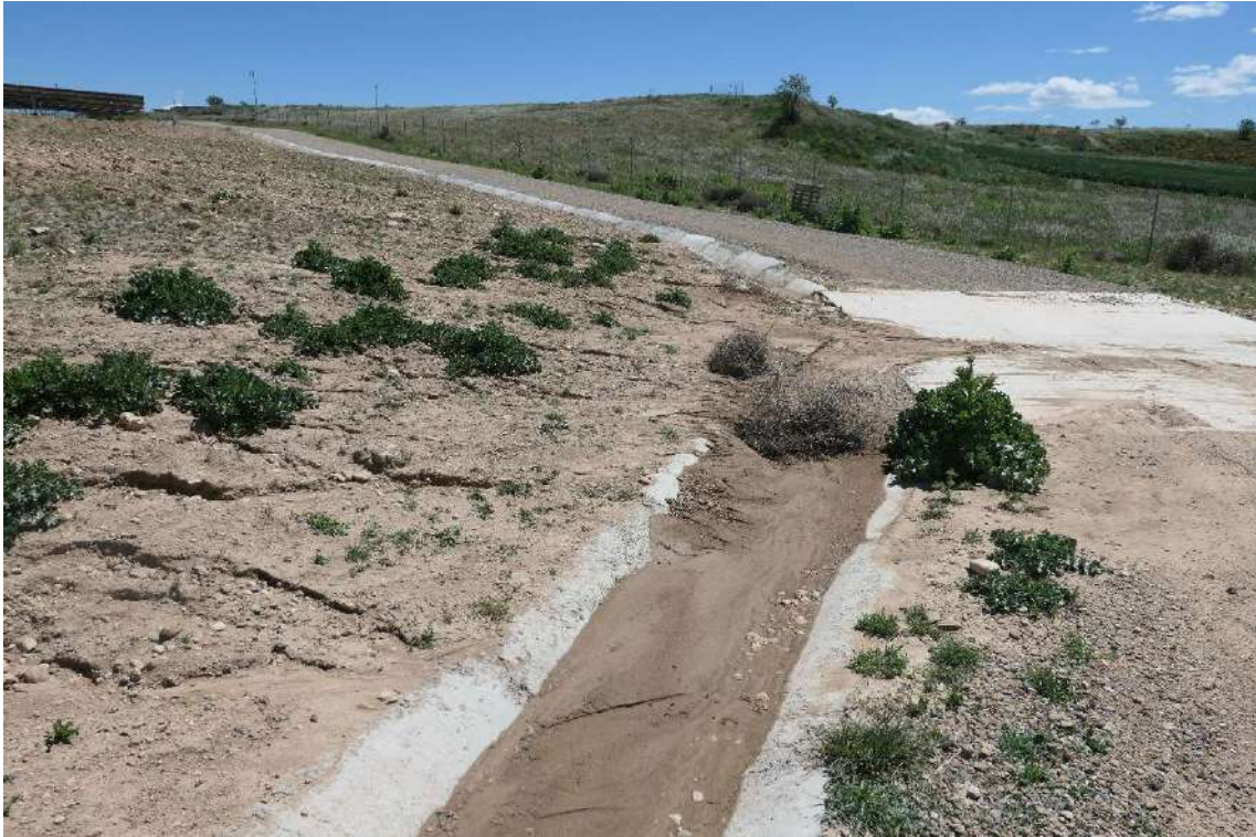
Imagen 9.- Punto de drenaje en la zona de cota más baja. Las acequias de hormigón se encuentran rellenas de tierra procedente de la erosión por la lluvia. No supone un problema en este momento, pero es posible que en el futuro haya que realizar una limpieza.
