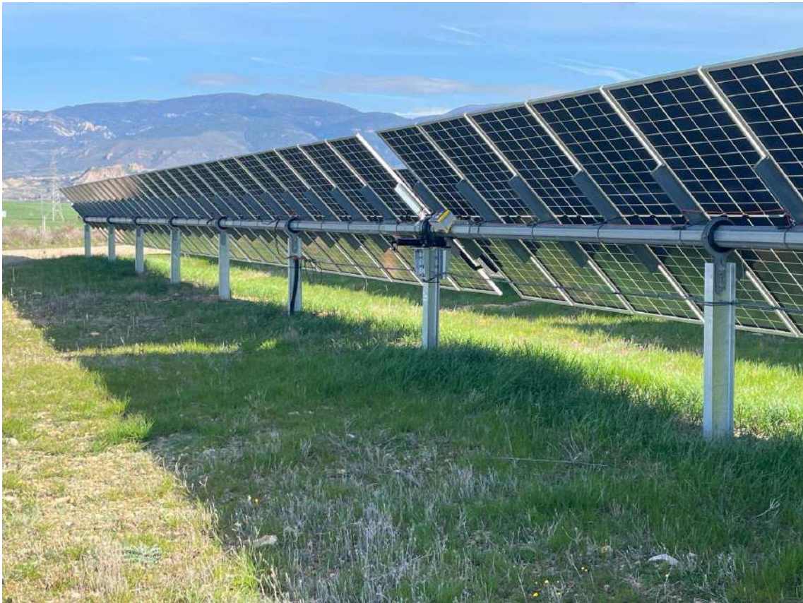
Imagen 17.- Vegetación bajo placas fotovoltaicas.
