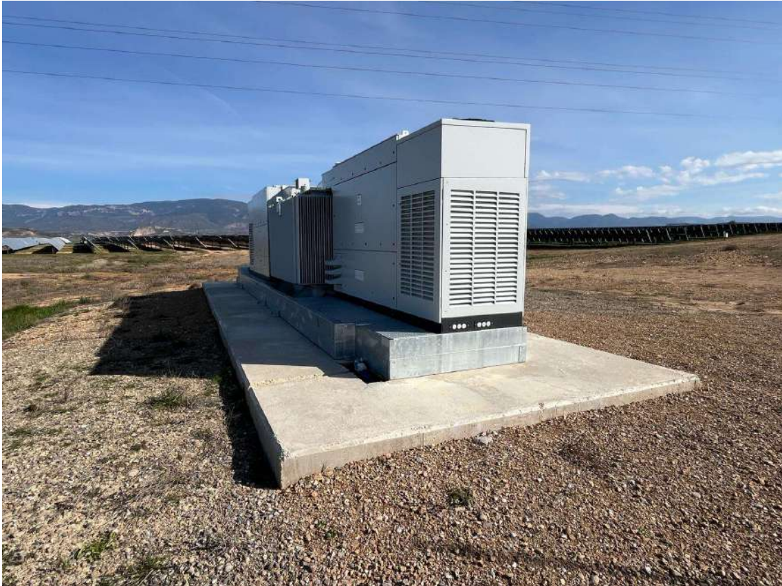
Imagen 18.- Centros eléctricos aislados mediante zona despejada de vegetación.
