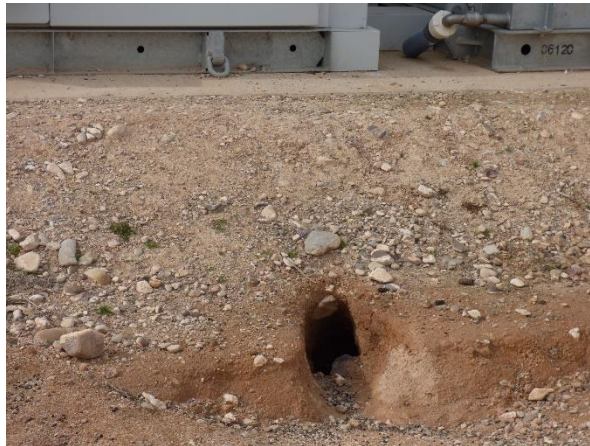
Imagen 15. Madriguera debajo un centro de transformación
