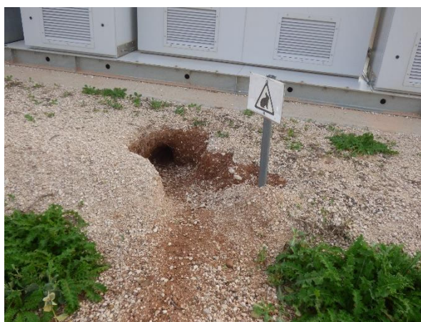
Imagen 15. Madriguera señalizada junto a un centro de transformación
