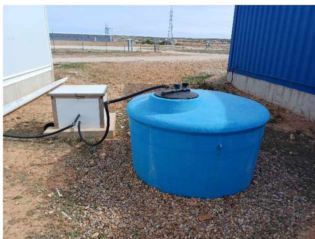
Imagen 2. Depósito para el almacenamiento de agua con destino a los aseos existentes en el edificio de O&M
