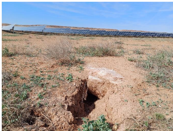
Imagen 15. Madriguera en el interior de una de las plantas fotovoltaicas
