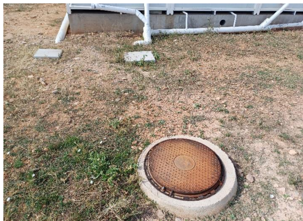
Imagen 1. Tuberías de salida de las aguas residuales del edificio de O&M y tapa de acceso al depósito estanco, sin evidencias de desbordamientos
