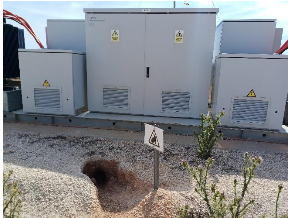
Imagen 14. Madriguera bajo uno de los centros de transformación
