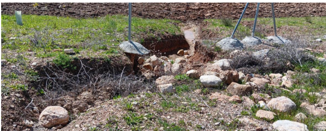
Puntos críticos de erosión que afectan al vallado de la parcela 1 en el mes de abril.
