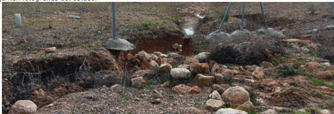
Puntos críticos de erosión que afectan al vallado de la parcela 1 en el mes de diciembre.
