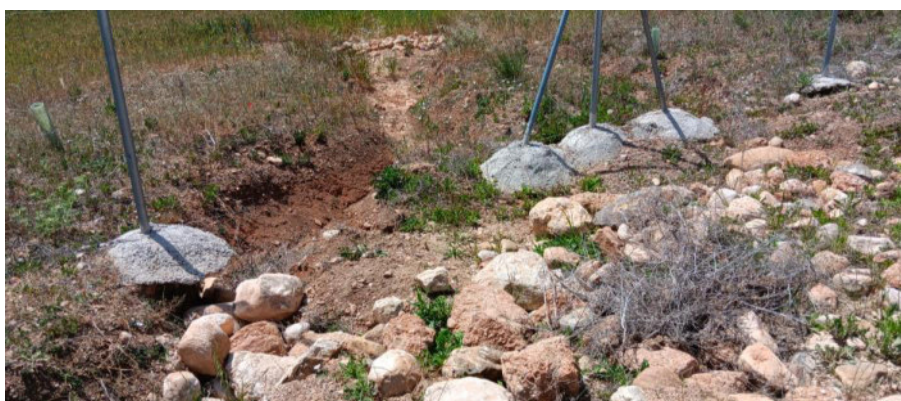
Puntos críticos de erosión que afectan al vallado de la parcela 1 en el mes de junio.
