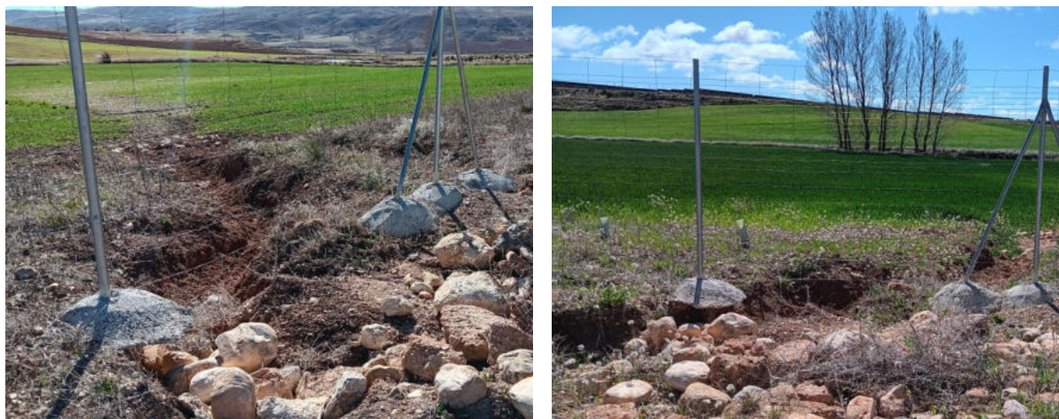
Erosiones que afectan al vallado de la parcela 1 en febrero (izq) y abril (dch).
