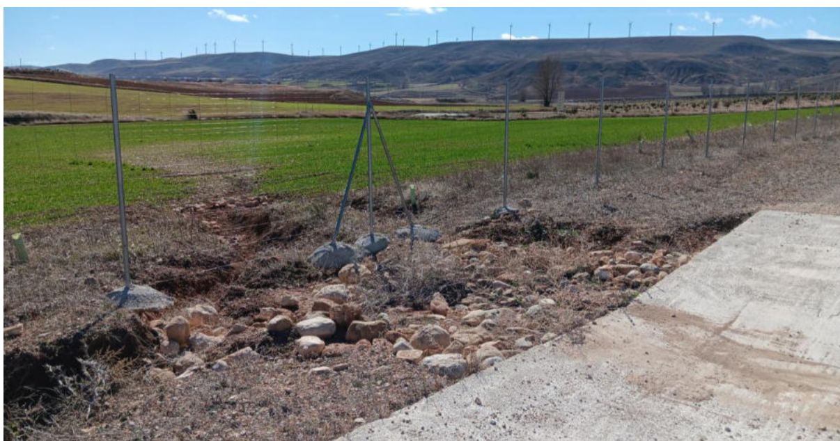
Drenaje limpio asociado a erosión en el vallado de cotas inferiores de la parcela 1 en febrero.
