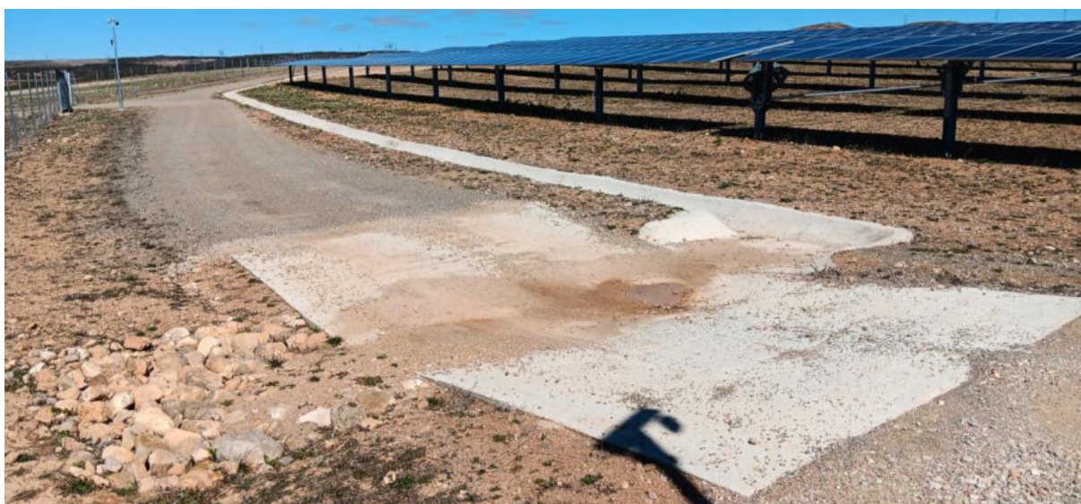
Drenaje con algo de material en el mes de marzo en la parcela 2.
