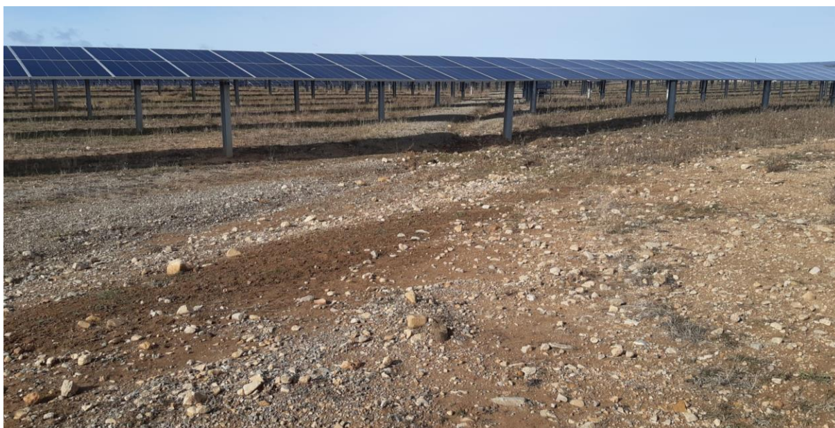
Escorrentía superficial macada a través de las filas de seguidores por la diferencia de nivel de la parcela.
