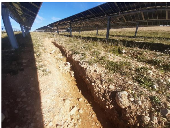
Surcos en los pasillos entre seguidores.
