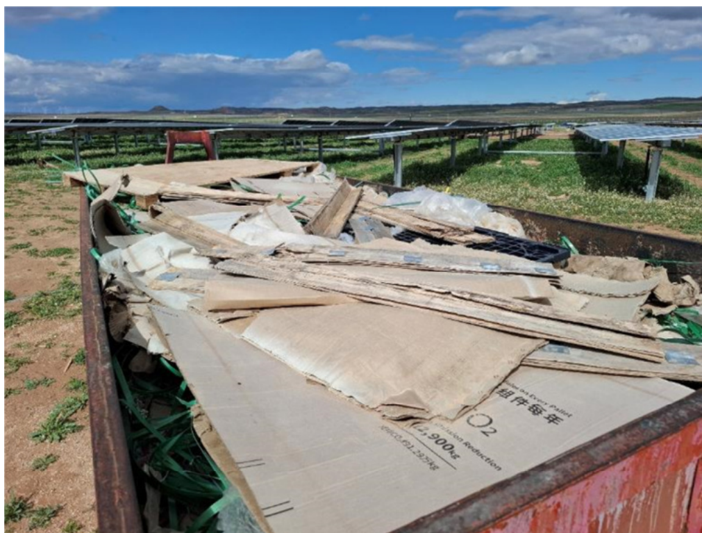
Figura 8.6. Contenedor con residuos de mezclados, instalado dentro de la planta "Épila"
