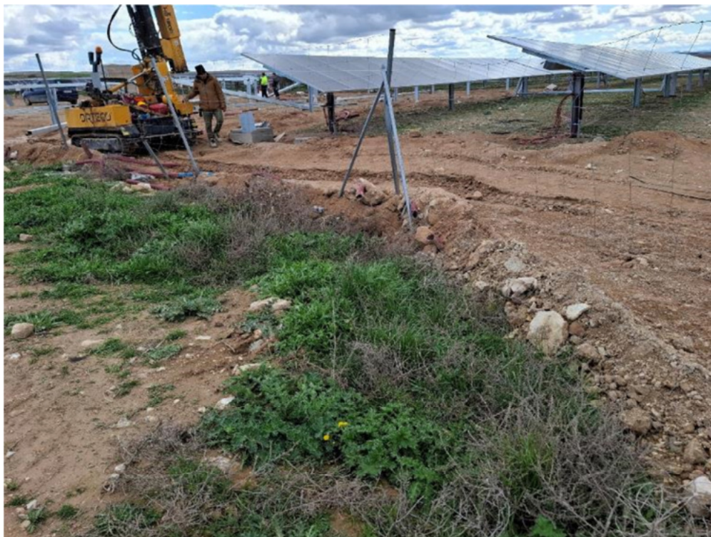
Figura 8.5. Paso inferior del vallado obstruido por restos de los acopios de tierras debido a la apertura de zanjas interiores. Se observa también el vallado roto en varios puntos.
