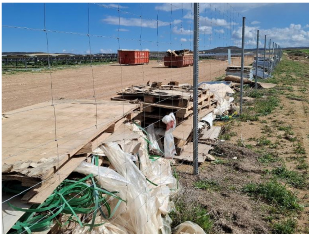
Figura 8.8. Acumulación de residuos en el límite sur de la planta
