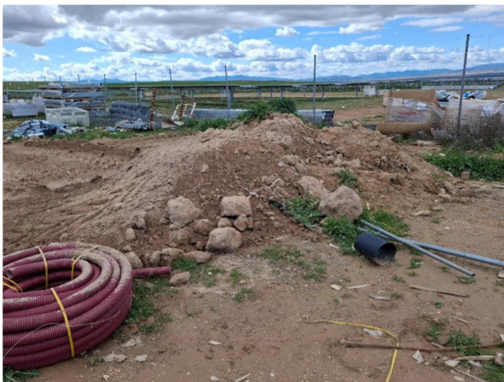
Figura 8.12. Acopio de tierra vegetal, sin balizar y rodeada de residuos, ubicado entre las plantas "San Pedro" y "Épila".
