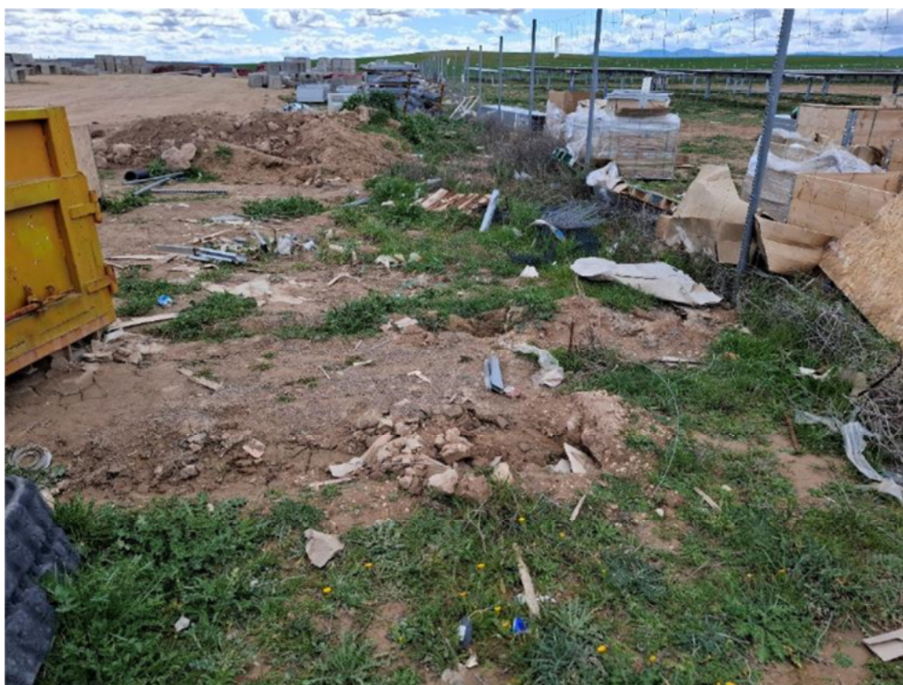
Figura 8.10. Residuos abundantes en el suelo, junto a los contenedores situados entre las plantas "Épila" y "San Pedro".
