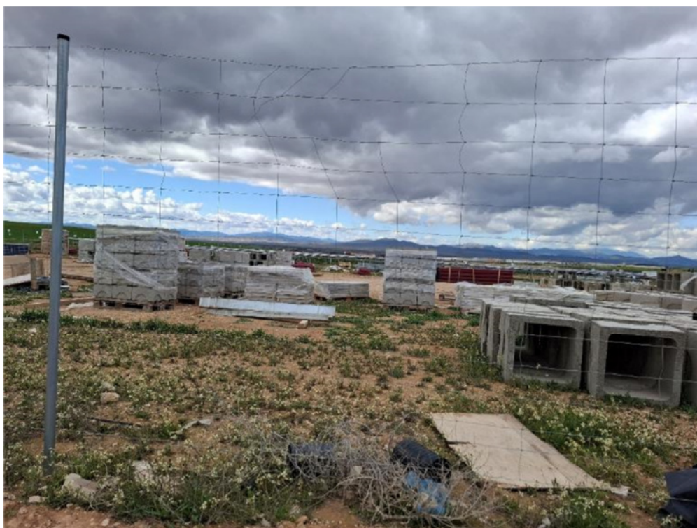
Figura 8.3. Vallado roto y placa ausente en el límite occidental de la planta
