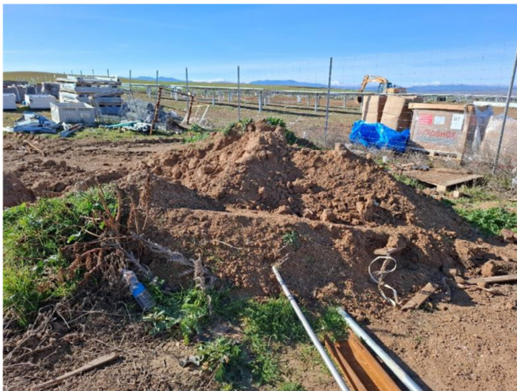
Figura 8.15. Acopio de tierra vegetal, sin balizar y rodeada de residuos, ubicado entre las plantas "San Pedro" y "Épila"
