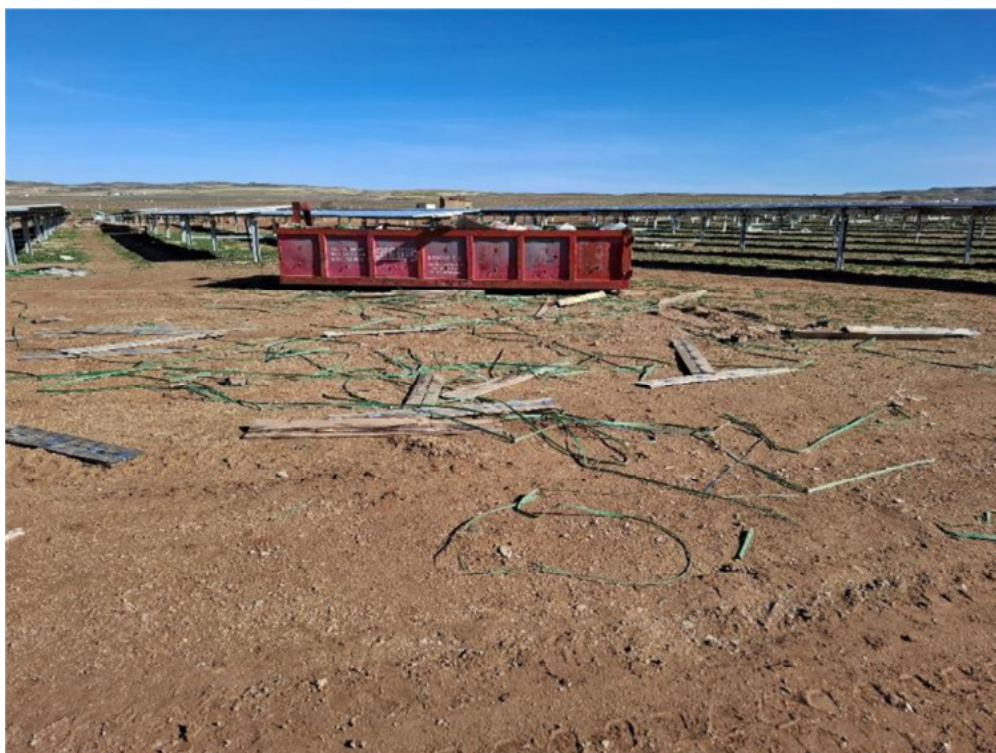
Figura 8.4. Acumulación de residuos junto a uno de los contenedores instalados dentro de la planta
