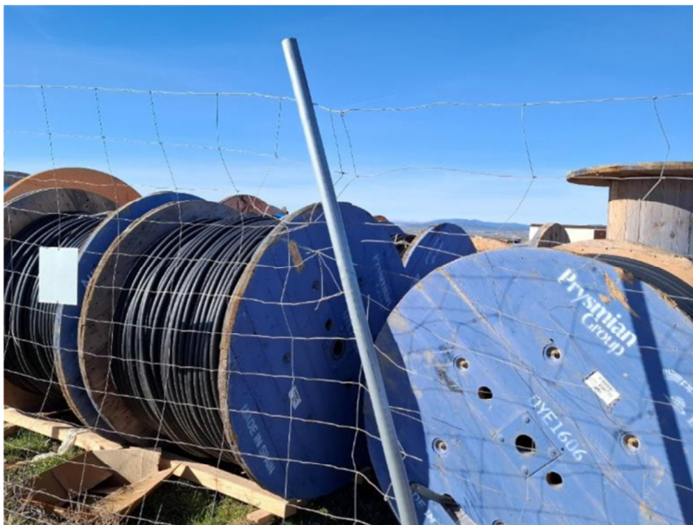
Figura 8.2. Vallado roto en el extremo occidental de la planta, con elementos punzantes peligrosos para la fauna
