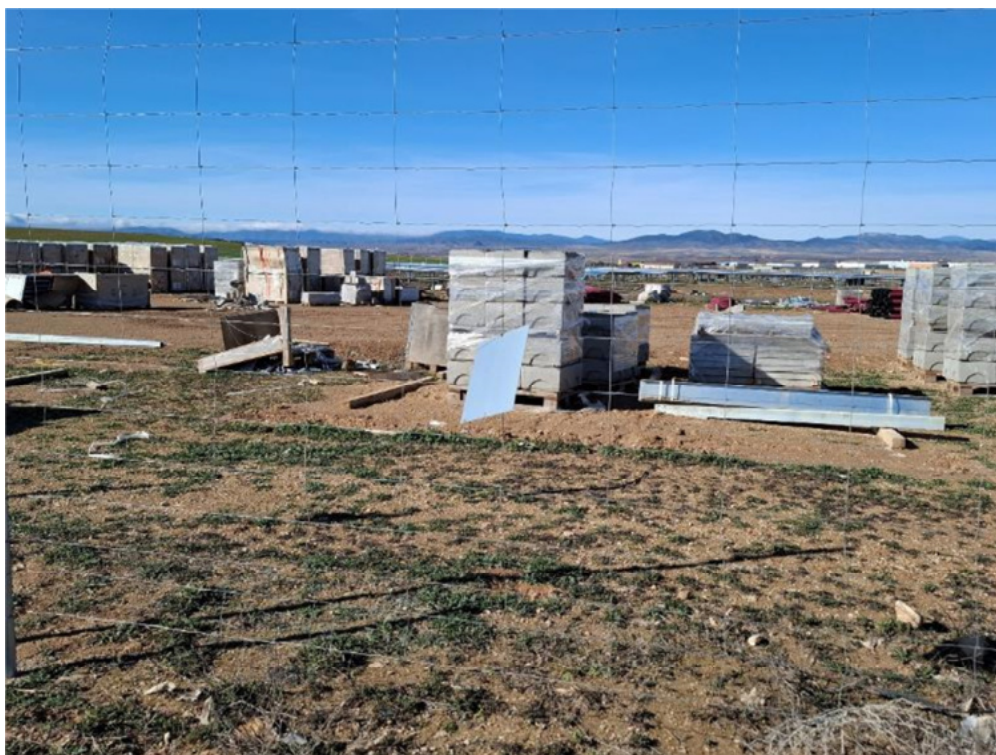
Figura 8.3. Placa sujeta al vallado por un único punto de anclaje, con riesgo de caída
