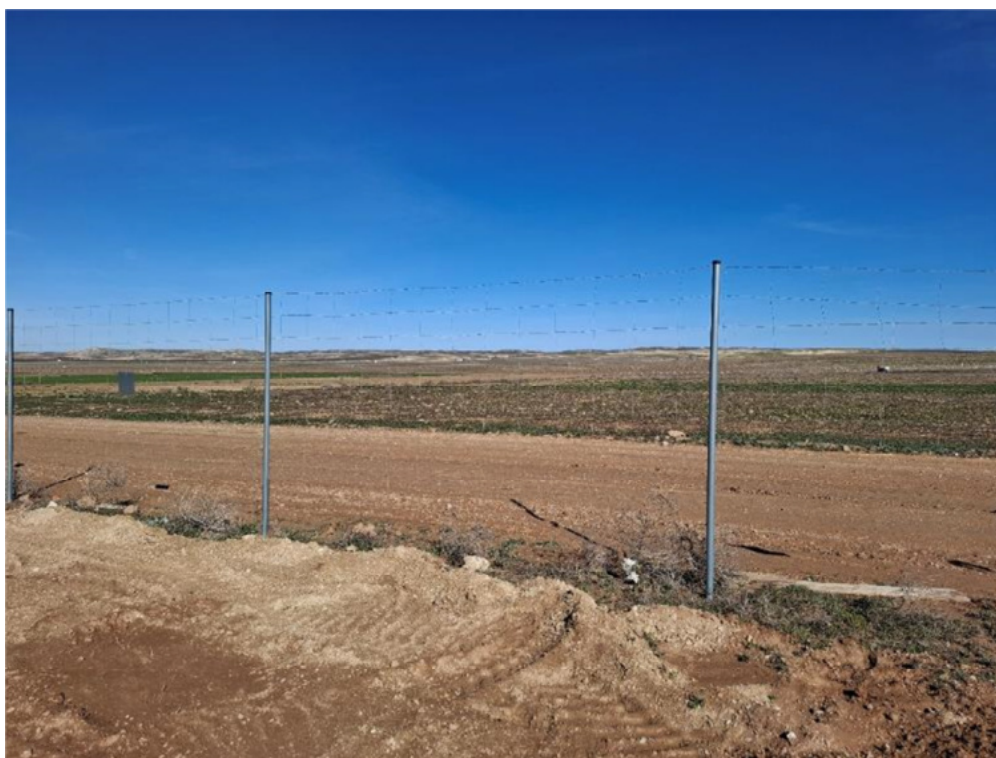
Figura 8.10. Placa ausente en un vano del vallado
