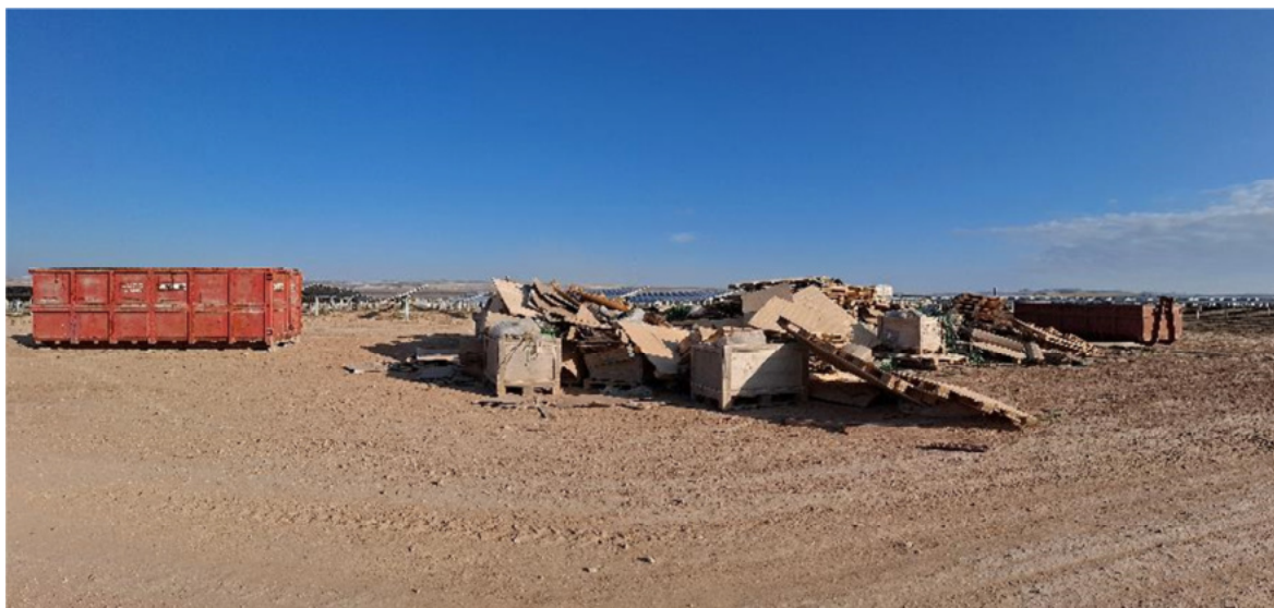
Figura 8.6. Acumulación de residuos junto a dos contenedores, instalados dentro de la planta
