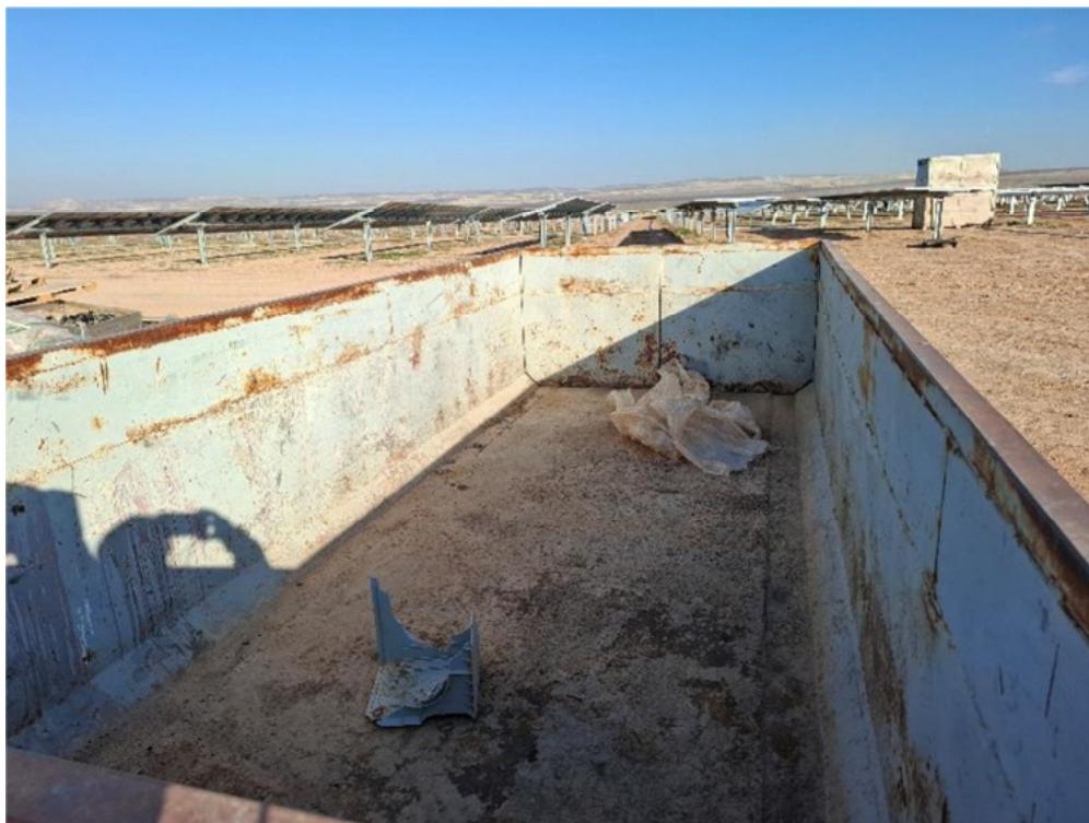
Figura 8.7. Contenedor vacío, instalado en la planta "Épila"
