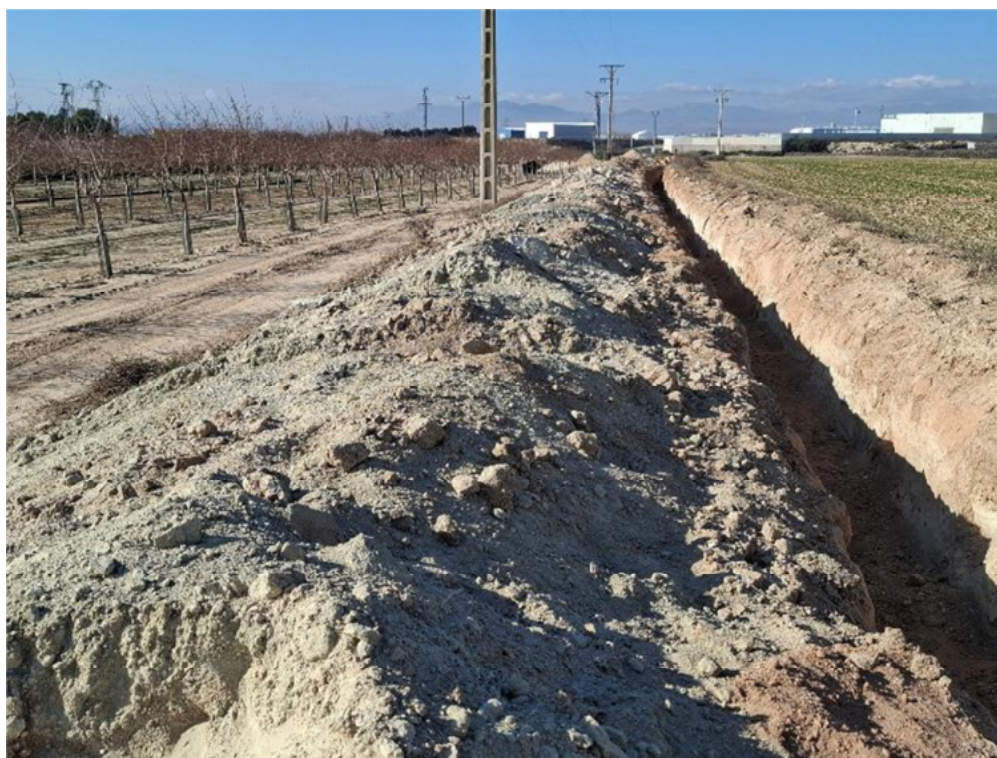
Figura 8.16. Zanja exterior alejada de la planta. No se están separando la tierra vegetal del resto de las tierras
