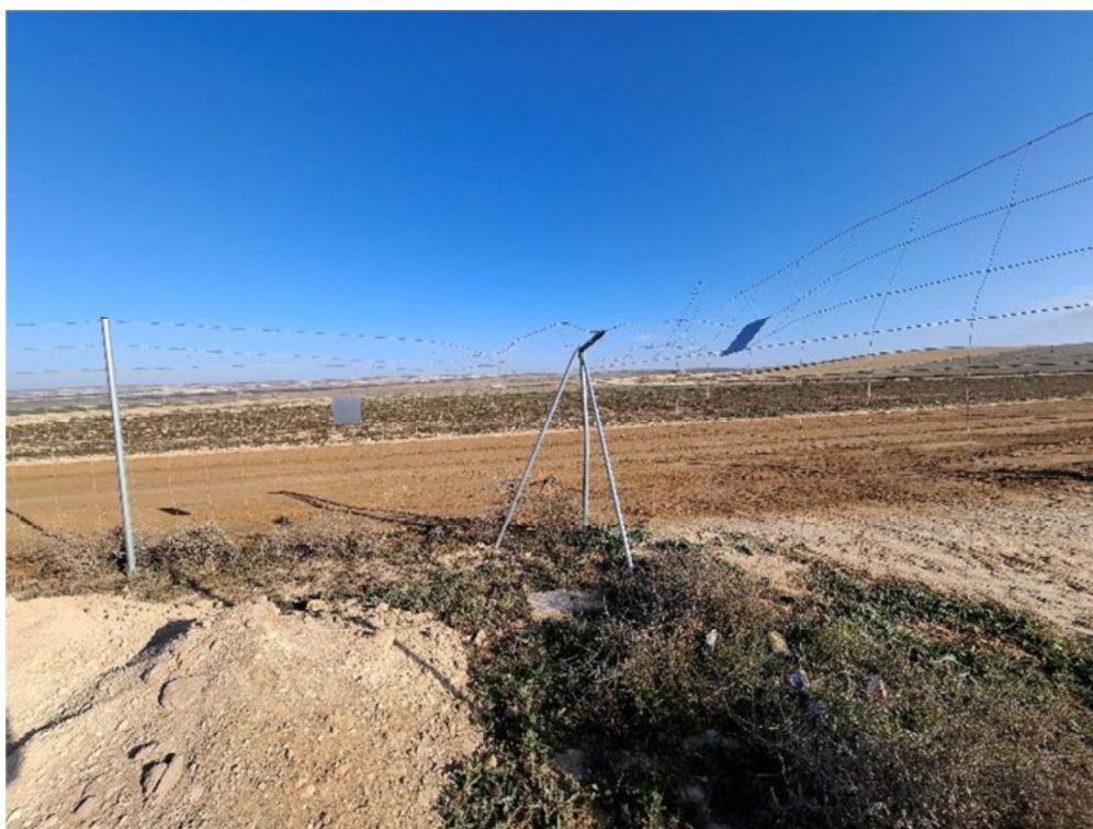
Figura 8.4. Vallado roto en el extremo nororiental de la planta, con elementos punzantes peligrosos para la fauna
