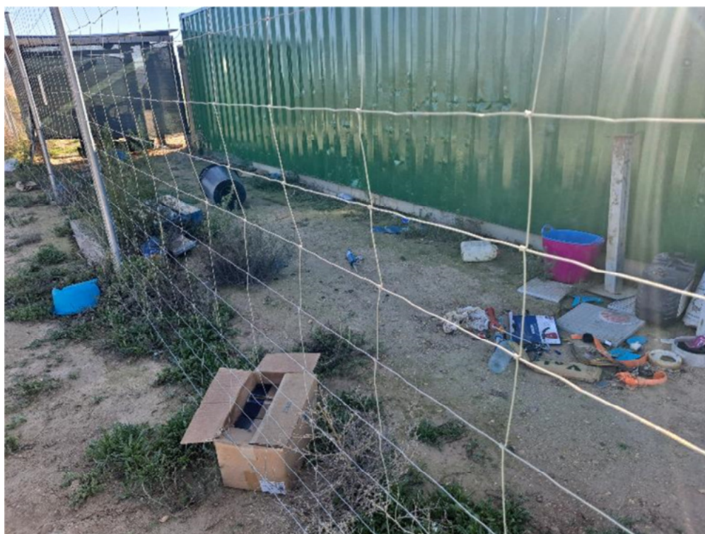
Figura 8.4. Residuos observados tras las casetas prefabricadas
