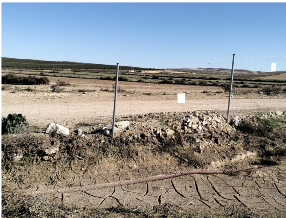
Figura 8.4. Obstrucción en el paso inferior del vallado
