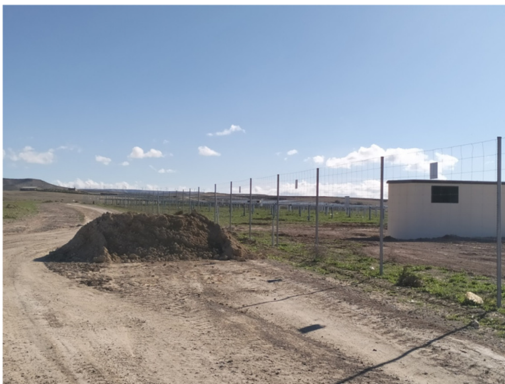
Figura 8.5. Acopio de tierras, sin balizar, en exterior del vallado, procedente de la excavación para instalación de Centro de Transformación
