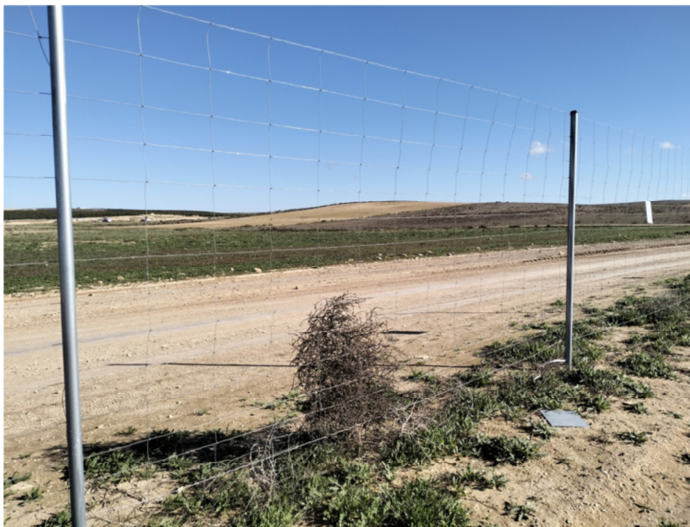
Figura 8.3. Placa ausente en un vano del vallado
