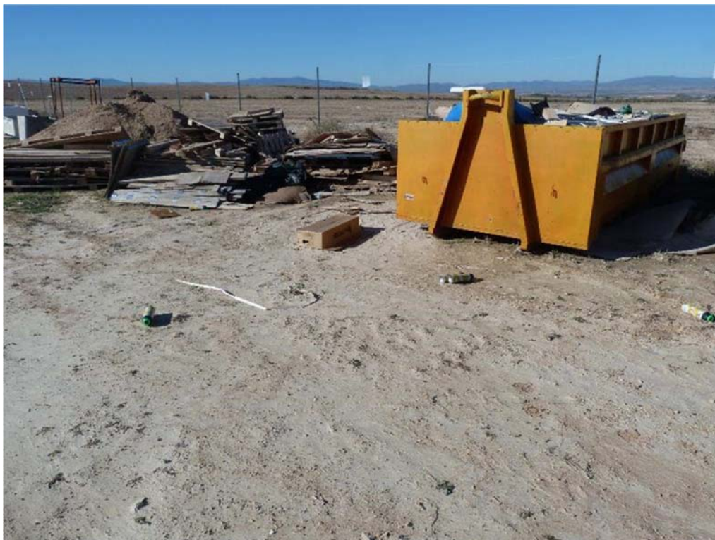
Figura 8.5. Residuos en parte depositados sobre el acopio de tierra vegetal
