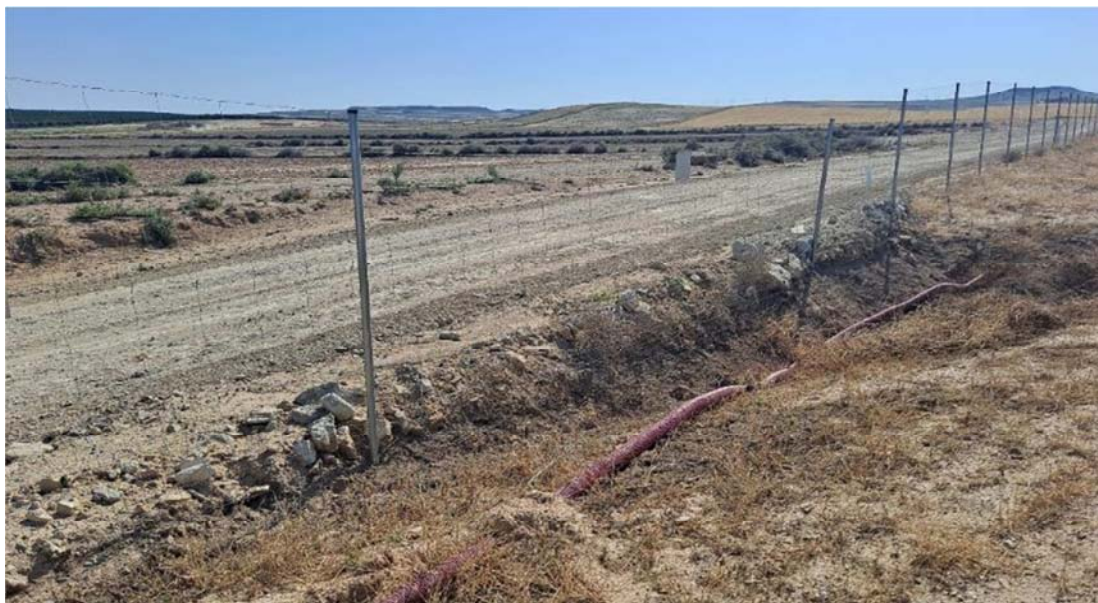
Figura 8.3. Obstrucción en el paso inferior del vallado
