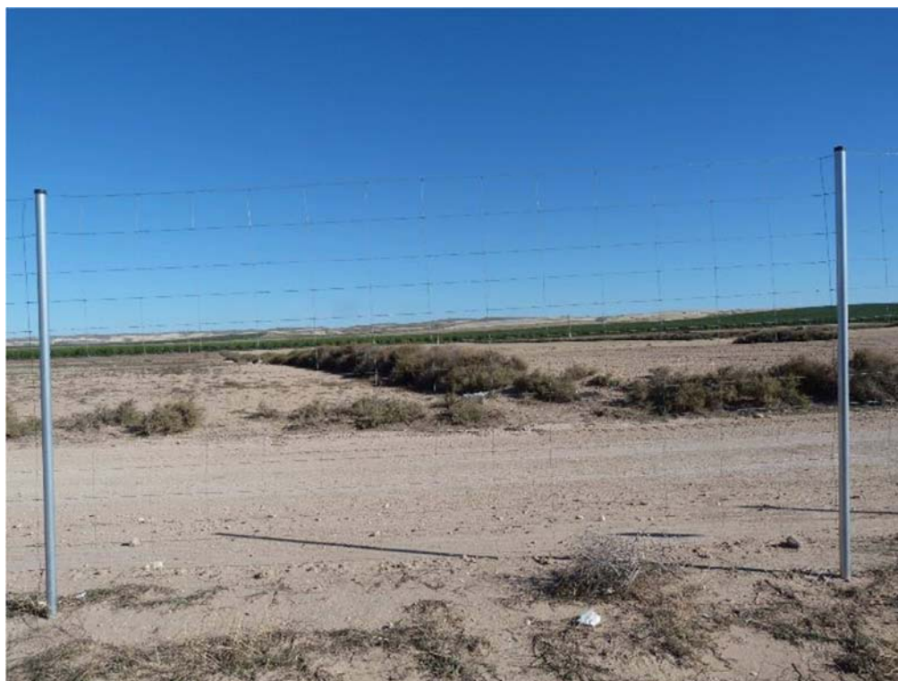
Figura 8.2. Placa ausente en un vano del vallado
