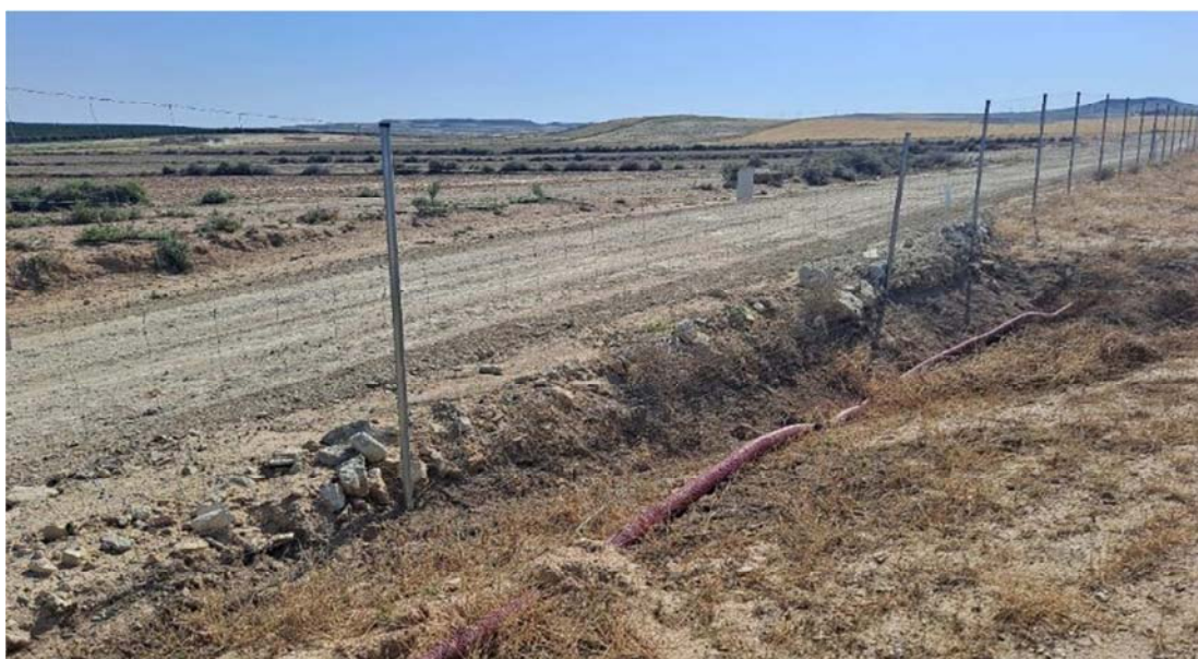
Figura 8.3. Obstrucción en el paso inferior del vallado
