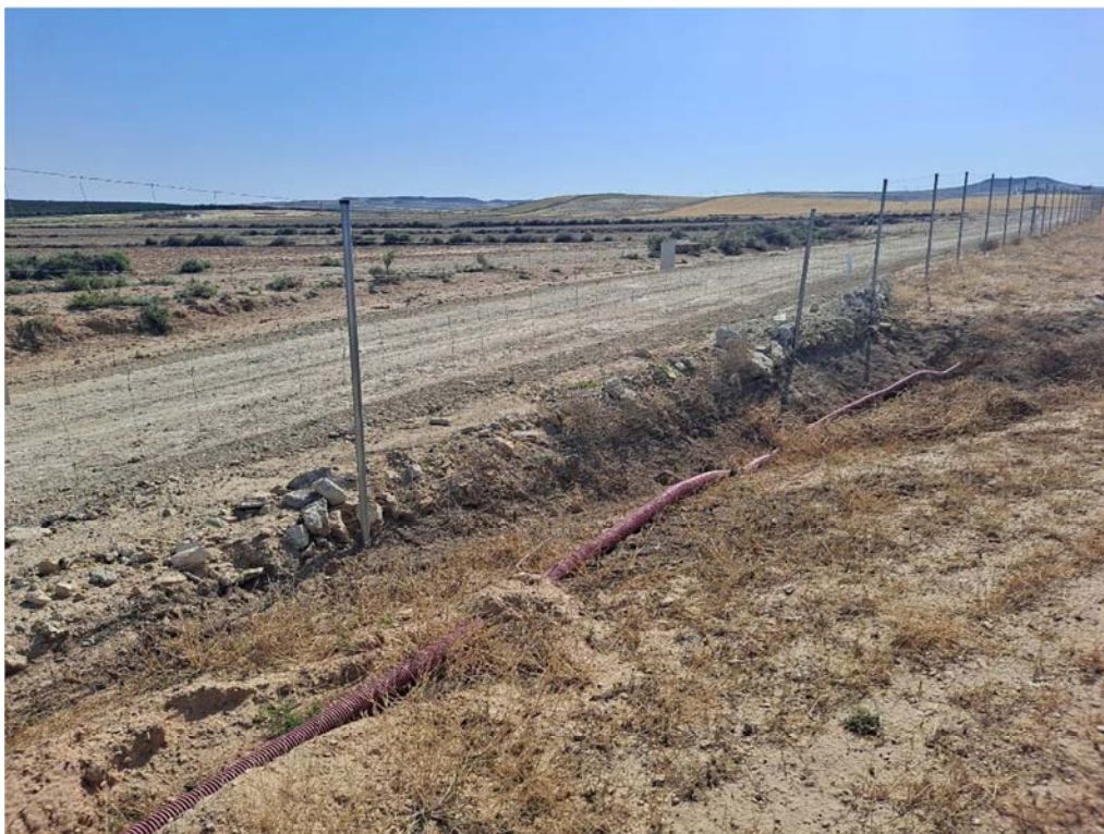
Figura 8.7. Paso inferior del vallado obstruido por los movimientos de tierra
