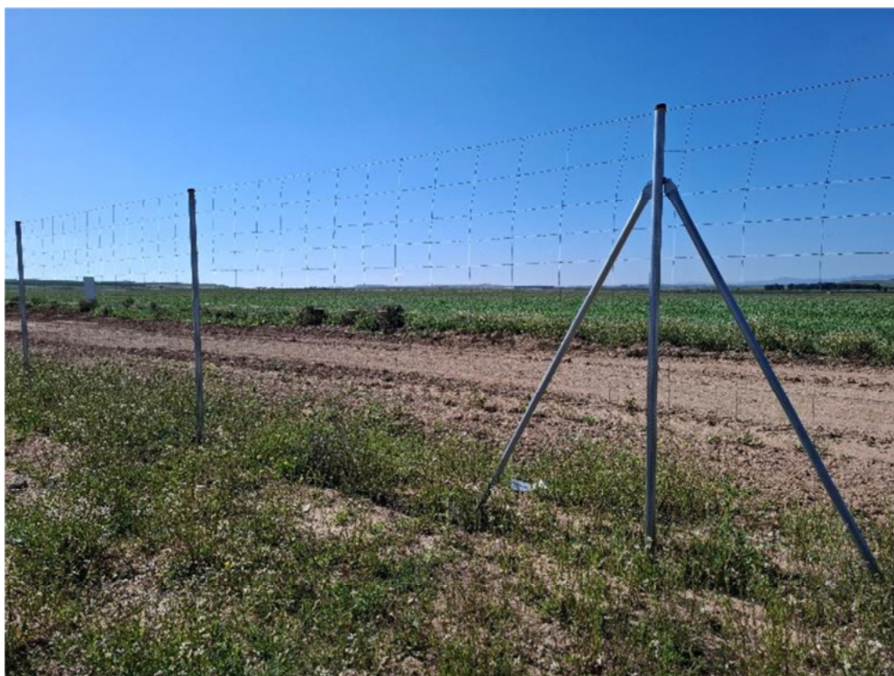
Figura 8.1. Placa ausente en el vallado, por el extremo sur de la planta
