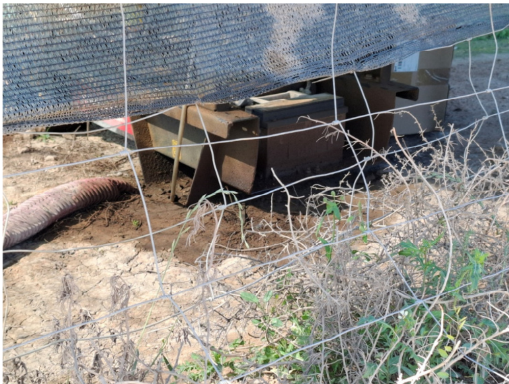
Figura 8.7. Mancha de combustible en el suelo, bajo el generador, que no dispone de cubeto de contención
