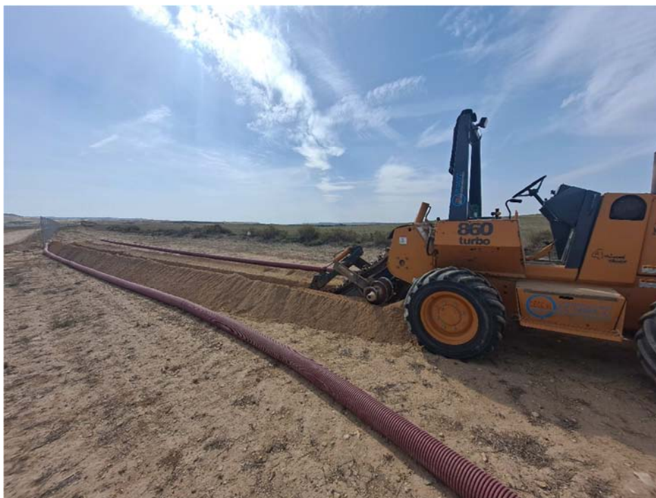
Figura 8.7. Ejecución de la zanja para la instalación de la línea de evacuación en el tramo entre las plantas "Épila" y "San Pedro"
