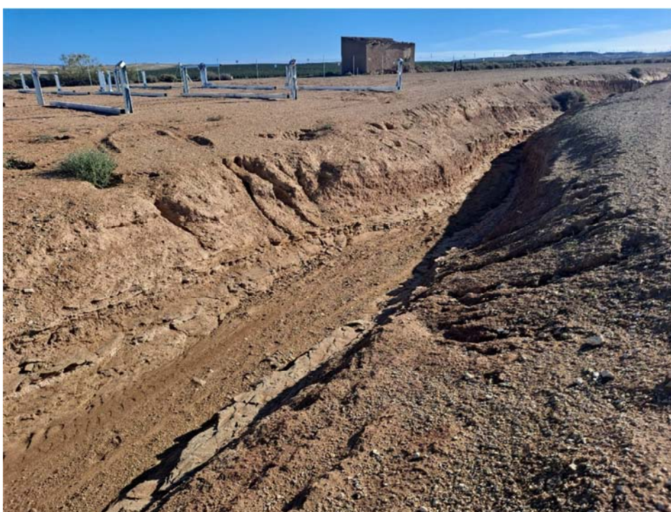
Figura 8.8. Lecho húmedo en el barranco que atraviesa la planta, tras un episodio de precipitaciones. Se observan también signos erosivos (regueros) en los márgenes del mismo.
