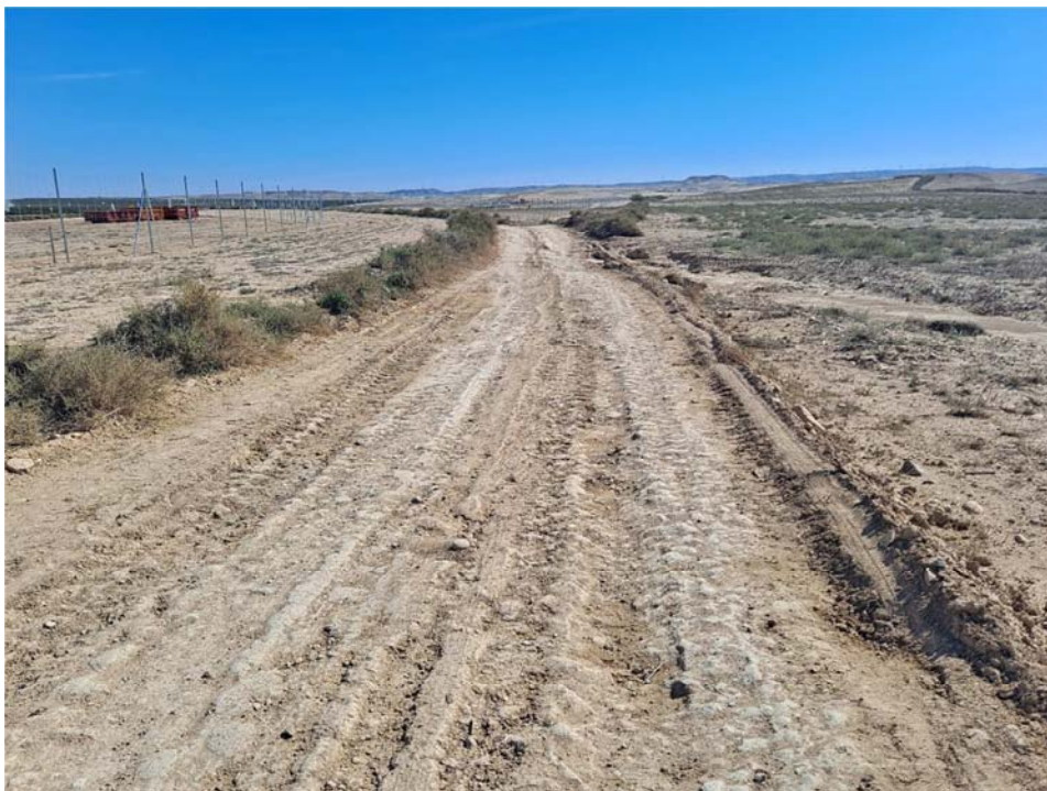
Figura 8.9. Aspecto de un tramo del camino de acceso con marcas de rodadas
