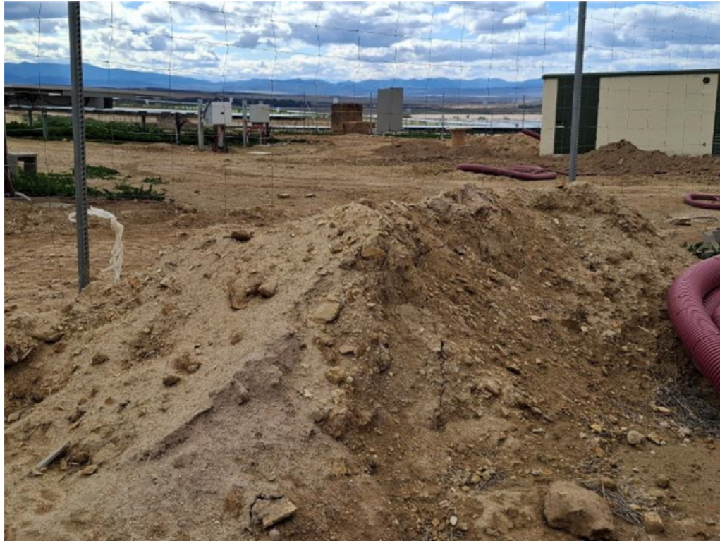
Figura 8.19. Obstrucción del paso inferior en un vano del vallado en el extremo norte de “Épila 1”
