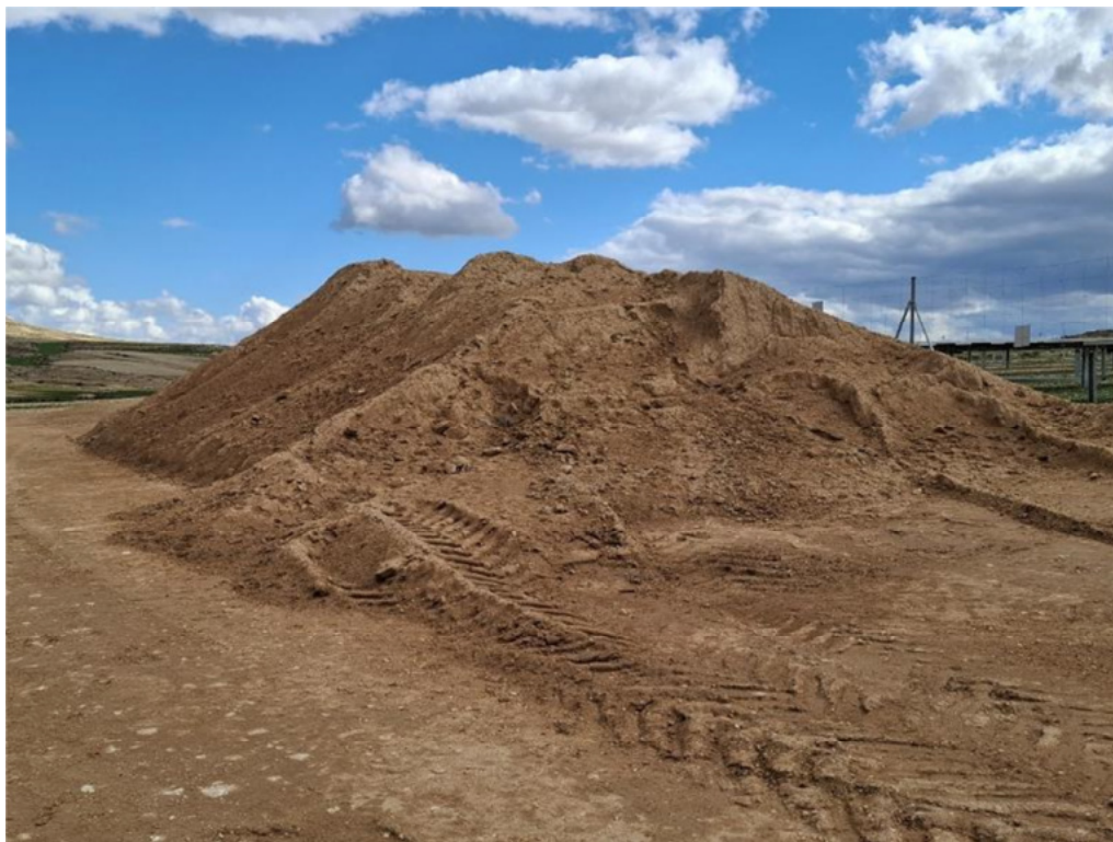
Figura 8.18. Acopios de tierra vegetal y otras tierras, en exterior de “Épila 1”. La tierra vegetal no se ha separado del resto de tierras.
