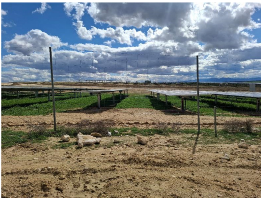
Figura 8.14. Placa ausente en un vano del vallado de “Épila 2B”
