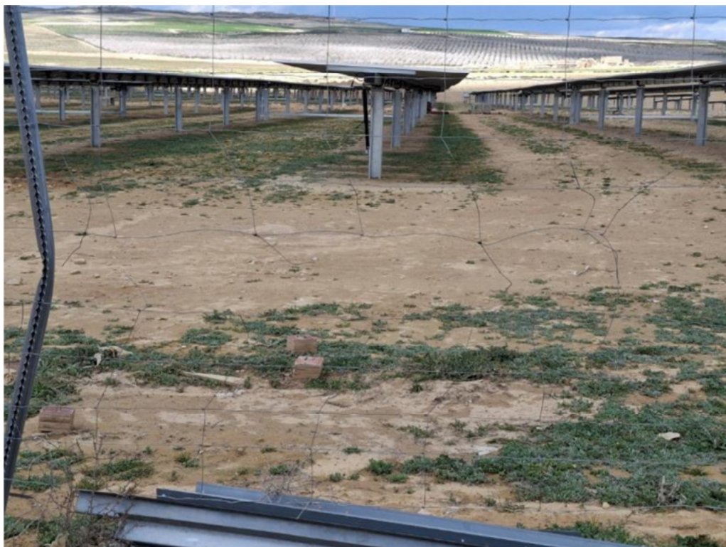
Figura 8.16. Vallado roto en un punto de la planta “Épila 1”
