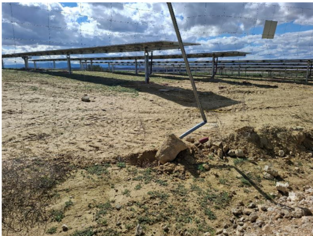
Figura 8.9. Poste doblado y vallado rodo en el extremo norte de la planta “Épila 2A”
