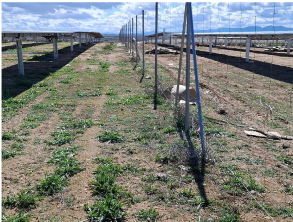
Figura 8.5. Residuos dispersos en el extremo oriental de la planta “Épila 3”, en su límite con la planta contigua “Épila”
