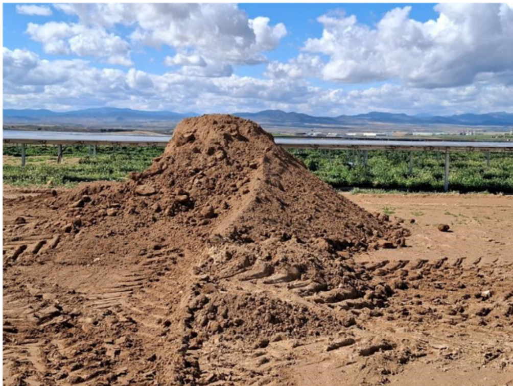
Figura 8.4. Acopio de tierra vegetal de 1,8 m de altura y sin balizar, localizado en "Épila 3"
