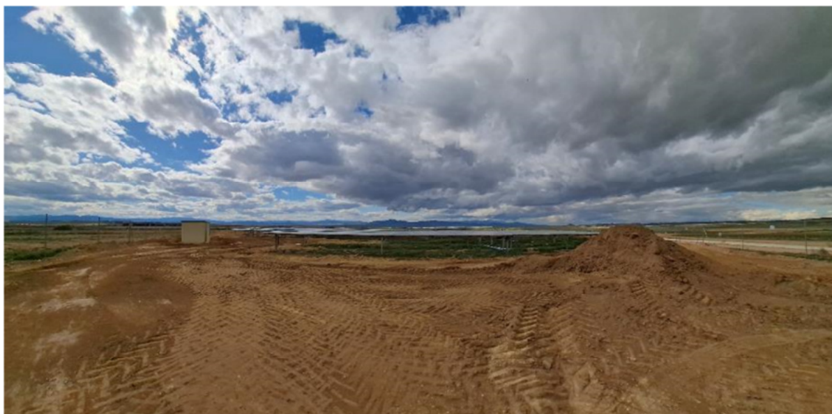
Figura 8.1. Aspecto de la planta “Épila 3”
