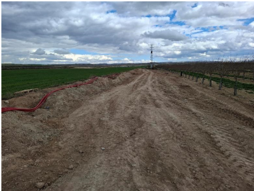
Figura 8.24. Camino de acceso con algunos baches, debido a los trabajos en la zanja exterior.
