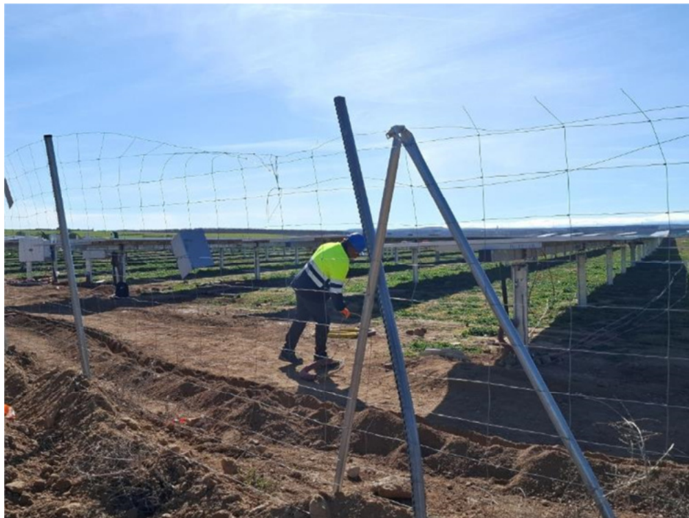
Figura 8.2. Vallado roto y placa ausente en el límite norte del vallado del recinto “Épila 3”
