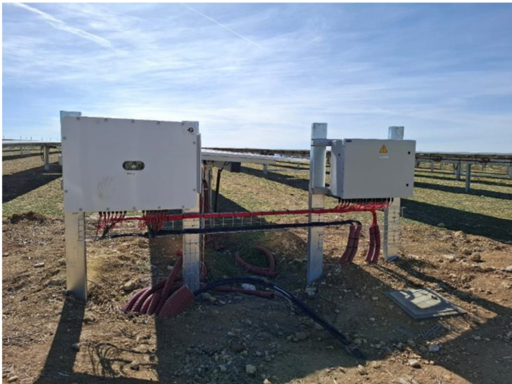
Figura 4.1. Cableado colocado en los inversores en el recinto “Épila 1”
