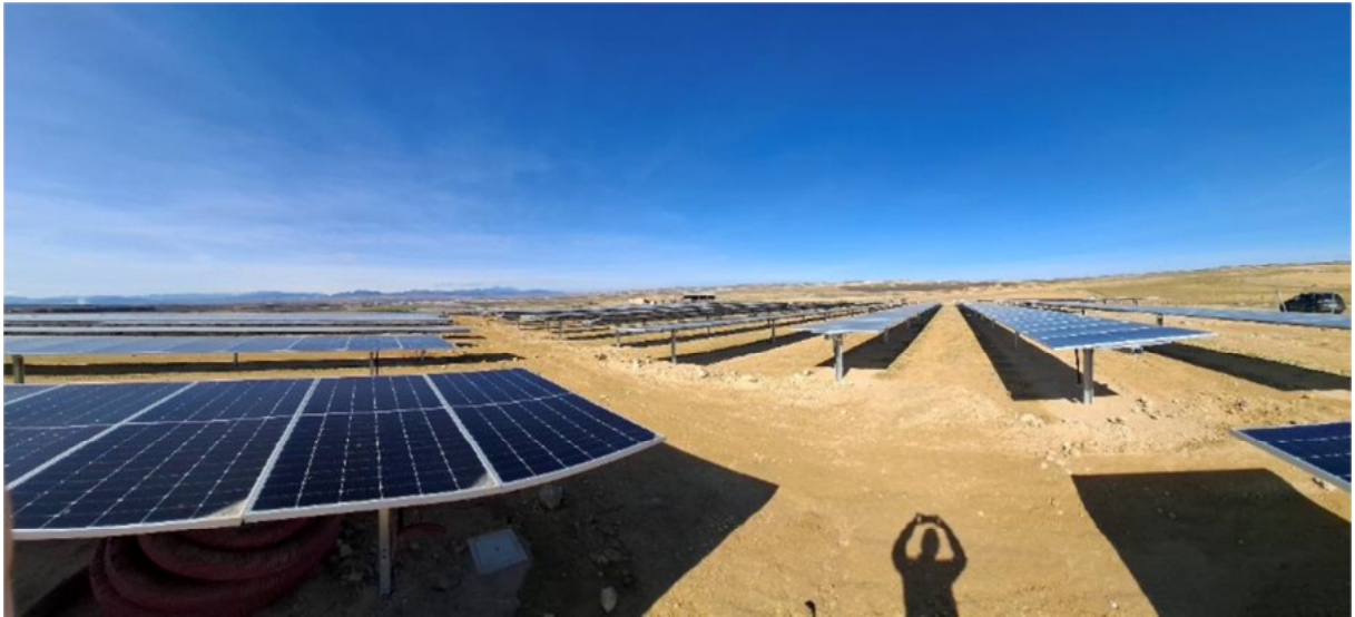
Figura 8.13. Aspecto de la planta “Épila 1”
