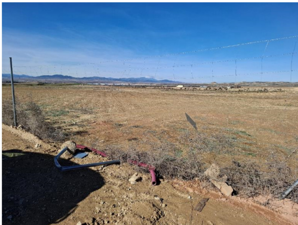
Figura 8.7. Poste roto, que genera alambres rotos peligrosos para la fauna en el extremo oeste de “Épila 2A”. Además, la placa de visibilidad está sujeta al vallado por un único punto de anclaje
