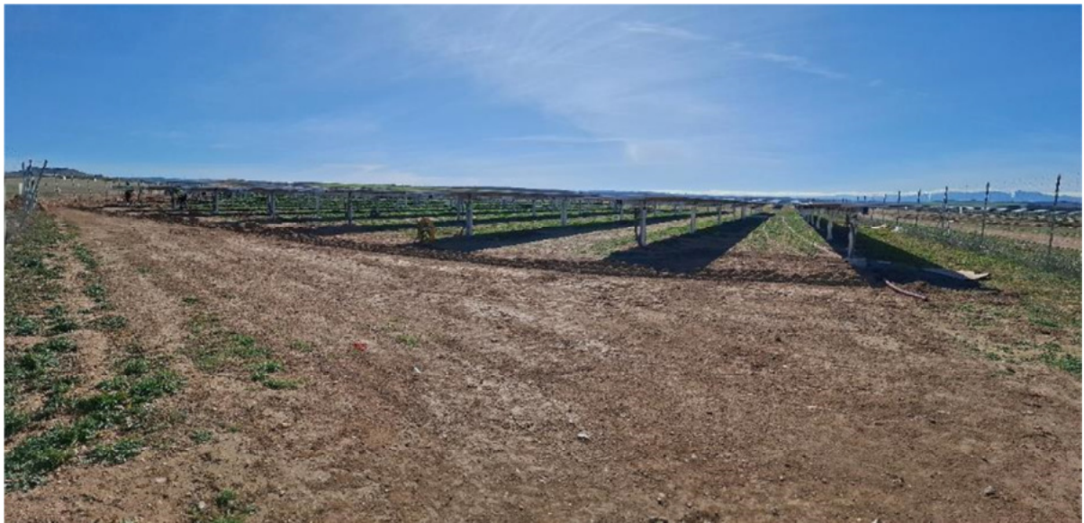
Figura 8.1. Aspecto de la planta “Épila 3”
