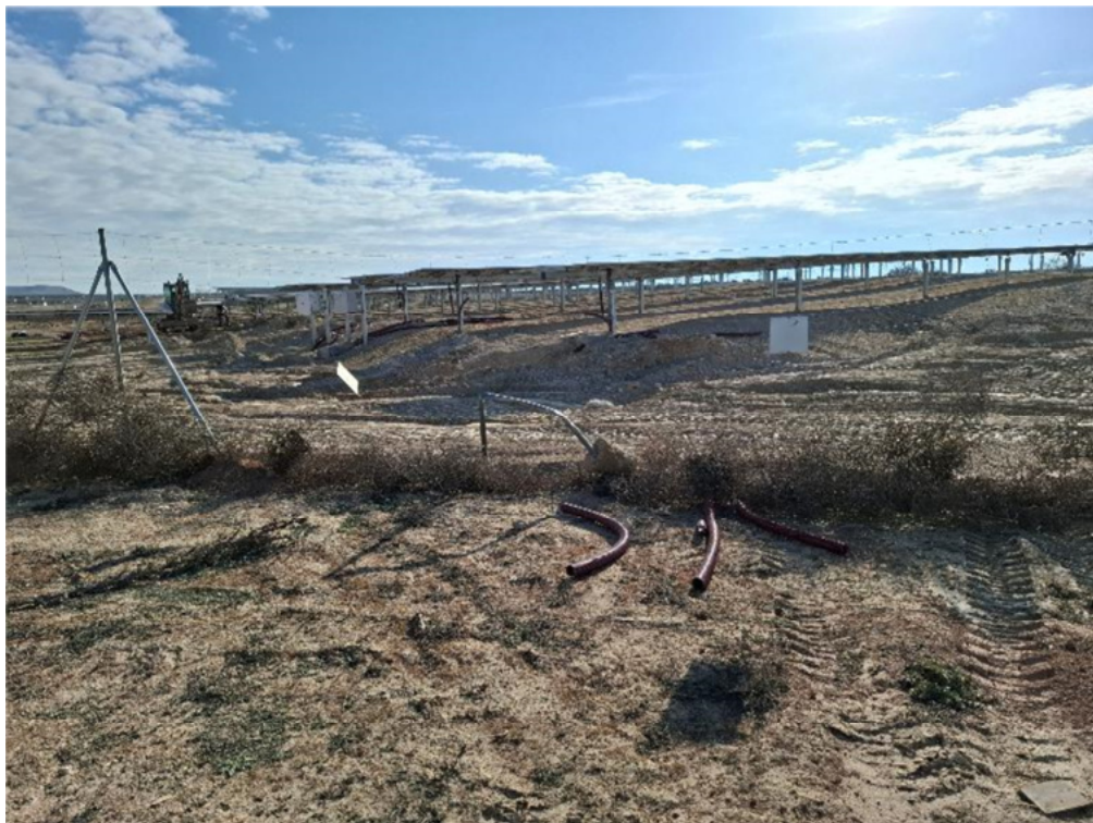
Figura 8.4. Poste doblado y vallado roto, con elementos punzantes, en “Épila 2A”
