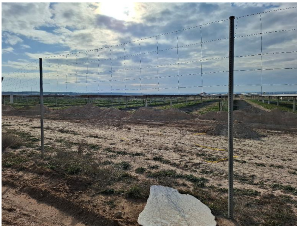
Figura 8.2. Placa de visibilidad ausente en el límite norte del vallado de “Épila 3”
