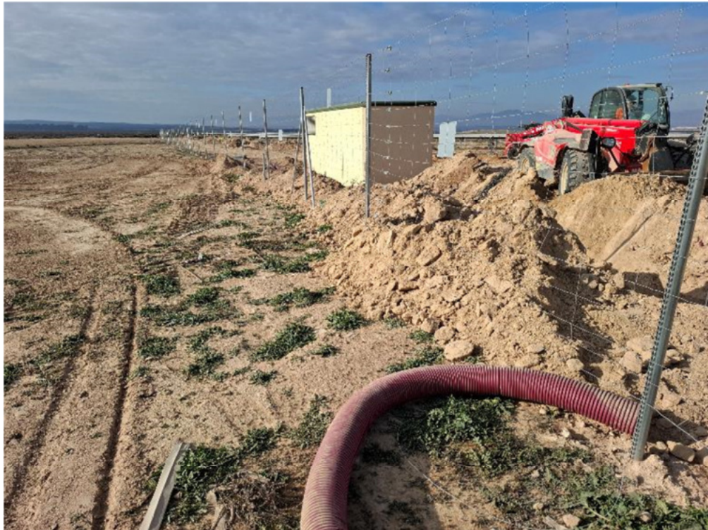
Figura 8.3. Obstrucción de un tramo del paso inferior de fauna en el vallado de “Épila 3”
