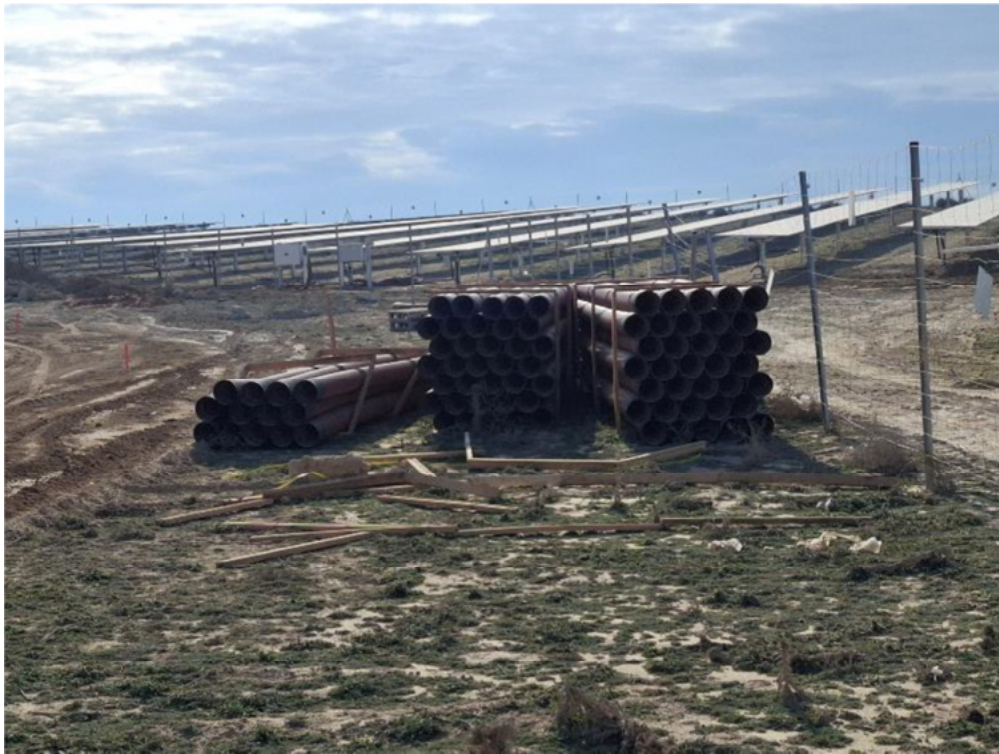
Figura 8.7. Acopio de tuberías en el exterior de “Épila 2A”.
