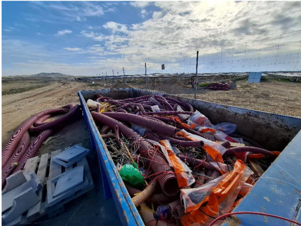
Figura 8.11. Contenedor instalado en el exterior de “Épila 1”, para almacenar los residuos plásticos.
