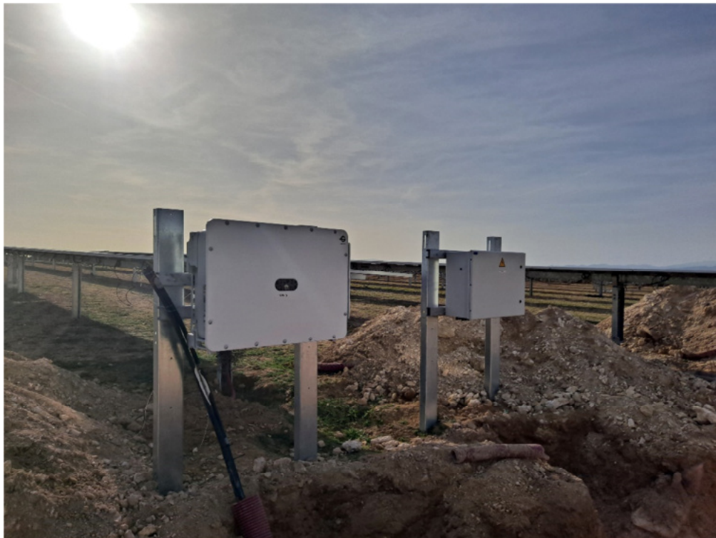
Figura 8.15. Inversores instalados en "Épila 1"
