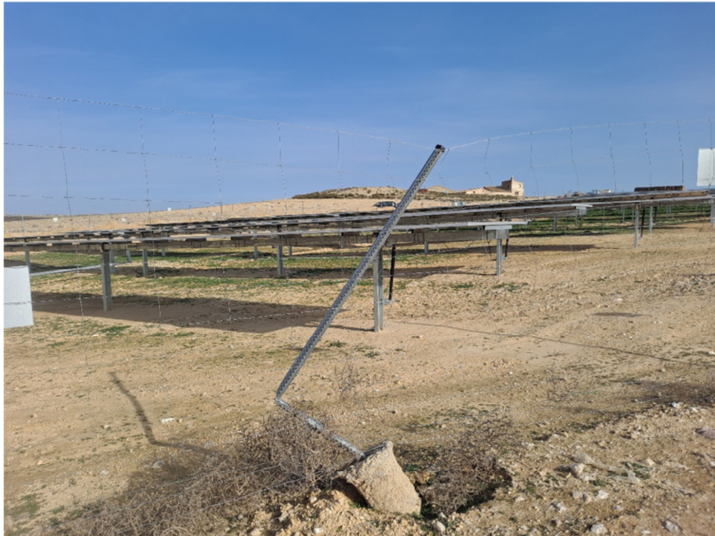
Figura 8.11. Poste doblado y vallado rodo en "Épila 2B"
