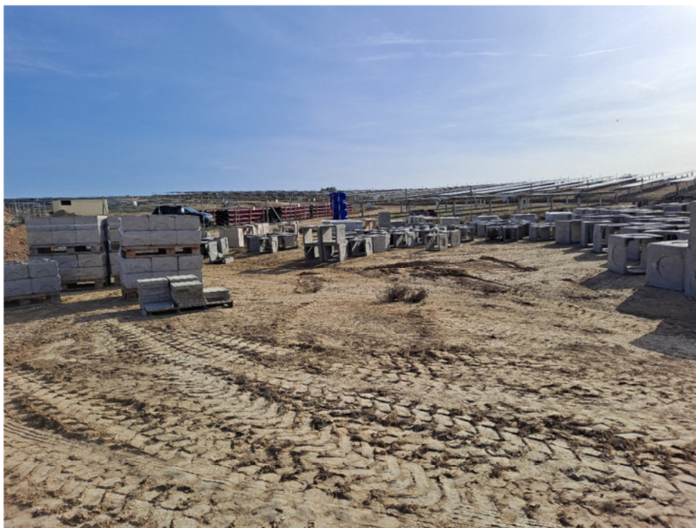
Figura 8.6. Acumulación de materiales en el exterior de “Épila 2A”
