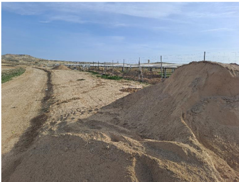
Figura 8.18. Acumulaciones de tierra en el perímetro exterior de “Épila 1”
