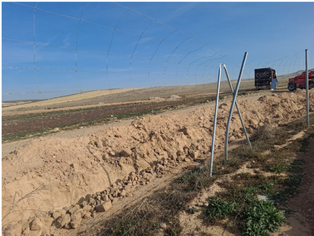
Figura 8.4. Poste doblado y vallado roto, con elementos punzantes, en “Épila 3”
