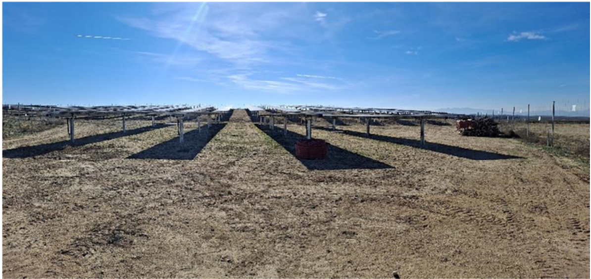
Figura 8.7. Aspecto de la planta “Épila 2A”
