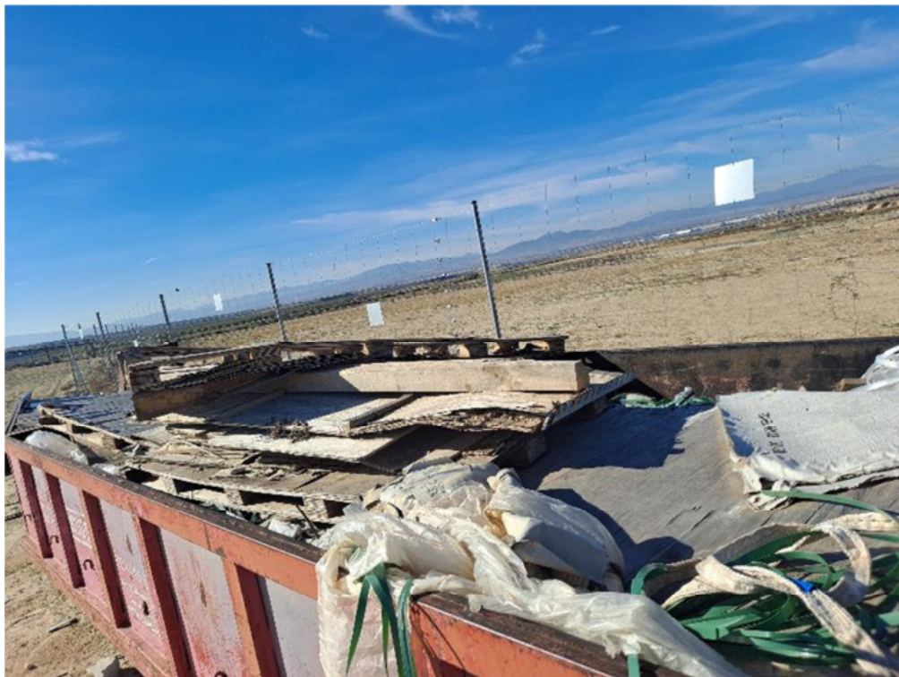
Figura 8.8. Contenedor de residuos situado en “Épila 2A”, con residuos mezclados.
