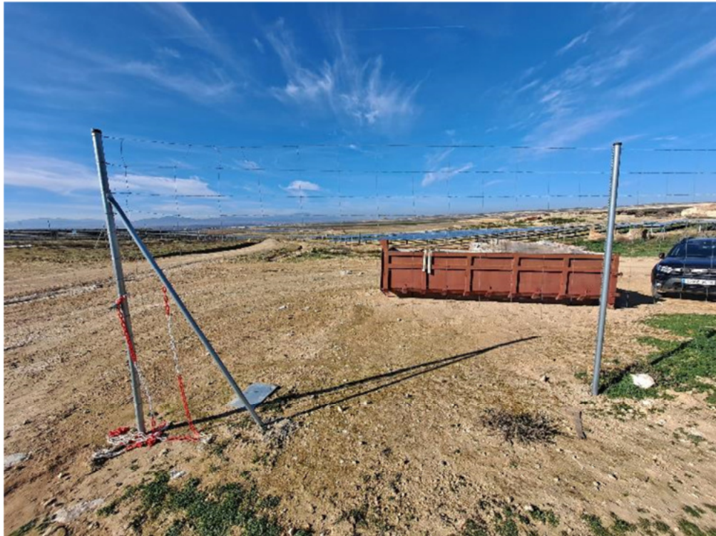
Figura 8.17. Placa ausente en el vallado de "Épila 1"
