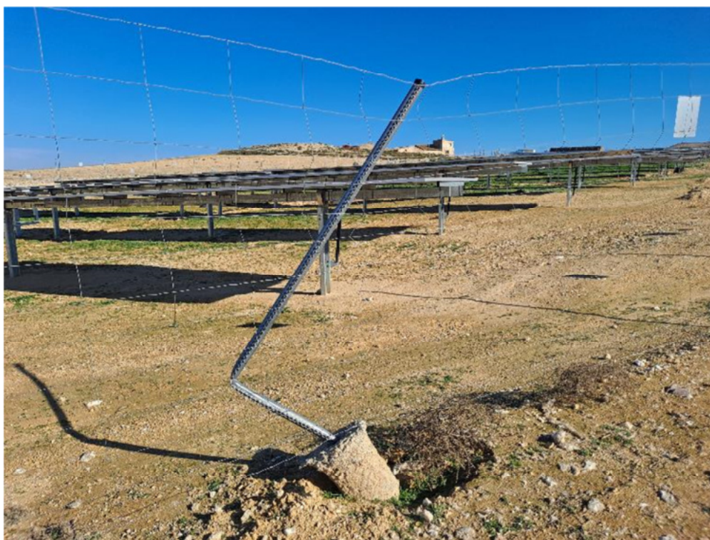
Figura 8.14. Poste doblado y vallado roto, generando elementos punzantes, en “Épila 2B”
