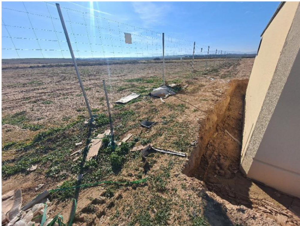
Figura 8.2. Residuos dispersos junto el centro de transformación instalado en “Épila 3”
