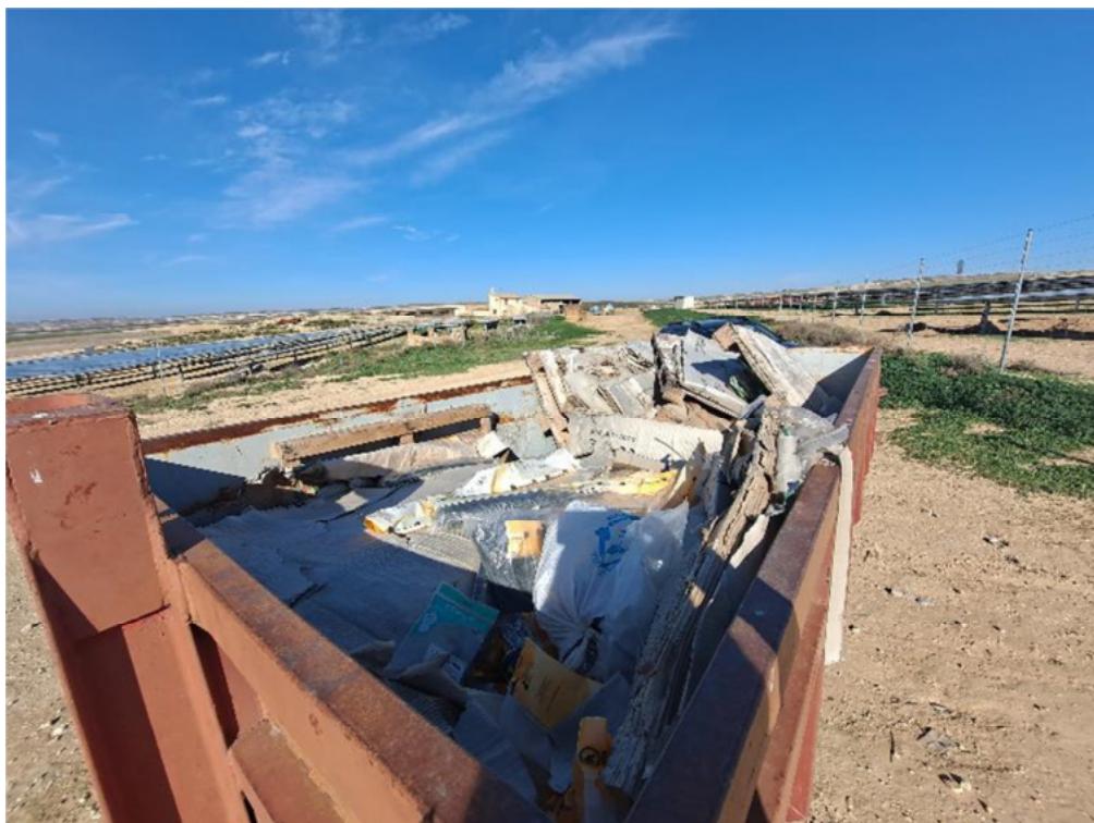
Figura 8.14. Residuos mezclados en el contenedor instalado en el exterior de “Épila 1”
