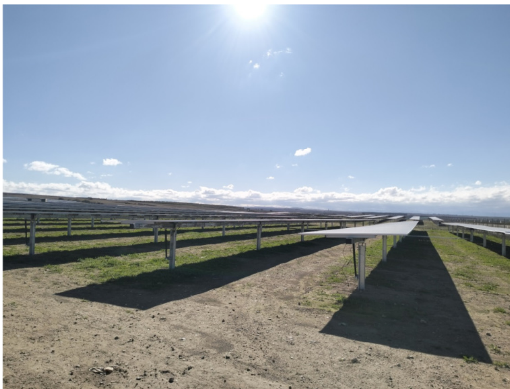
Figura 8.1. Aspecto de la planta “Épila 3”
