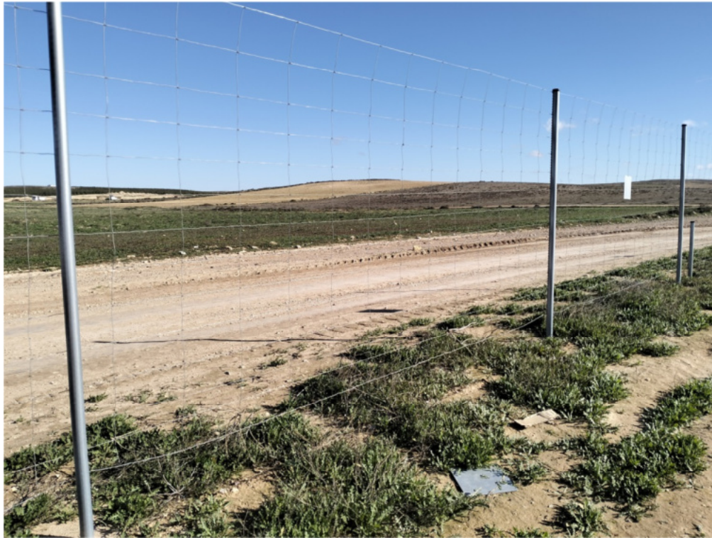
Figura 8.2. Placa ausente en un vano del vallado de “Épila 3”
