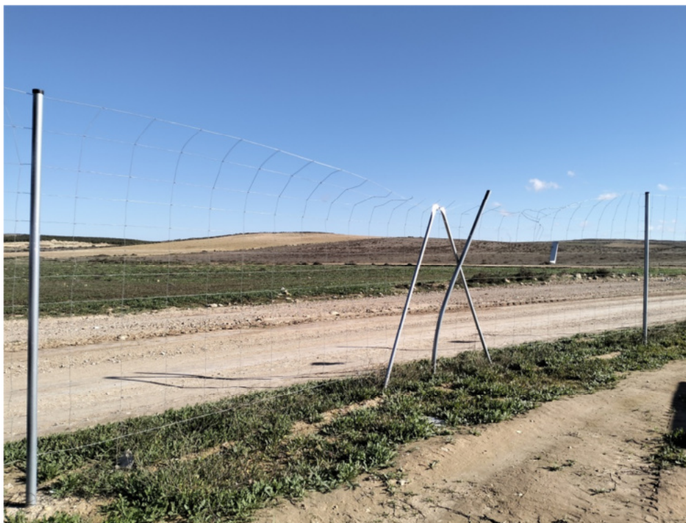
Figura 8.2. Vallado doblado y roto, que genera elementos punzantes en “Épila 3”
