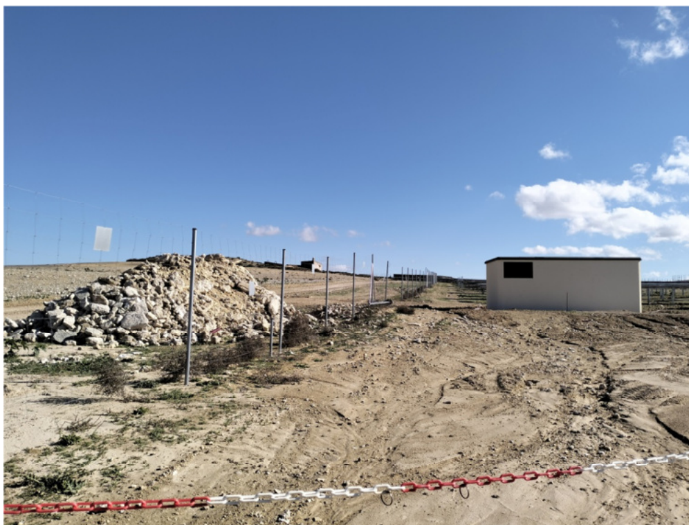
Figura 8.4. Acopios de tierras y rocas en exterior del vallado de “Épila 2B” procedente de ribazos, próximo a Centro de Transformación instalado
