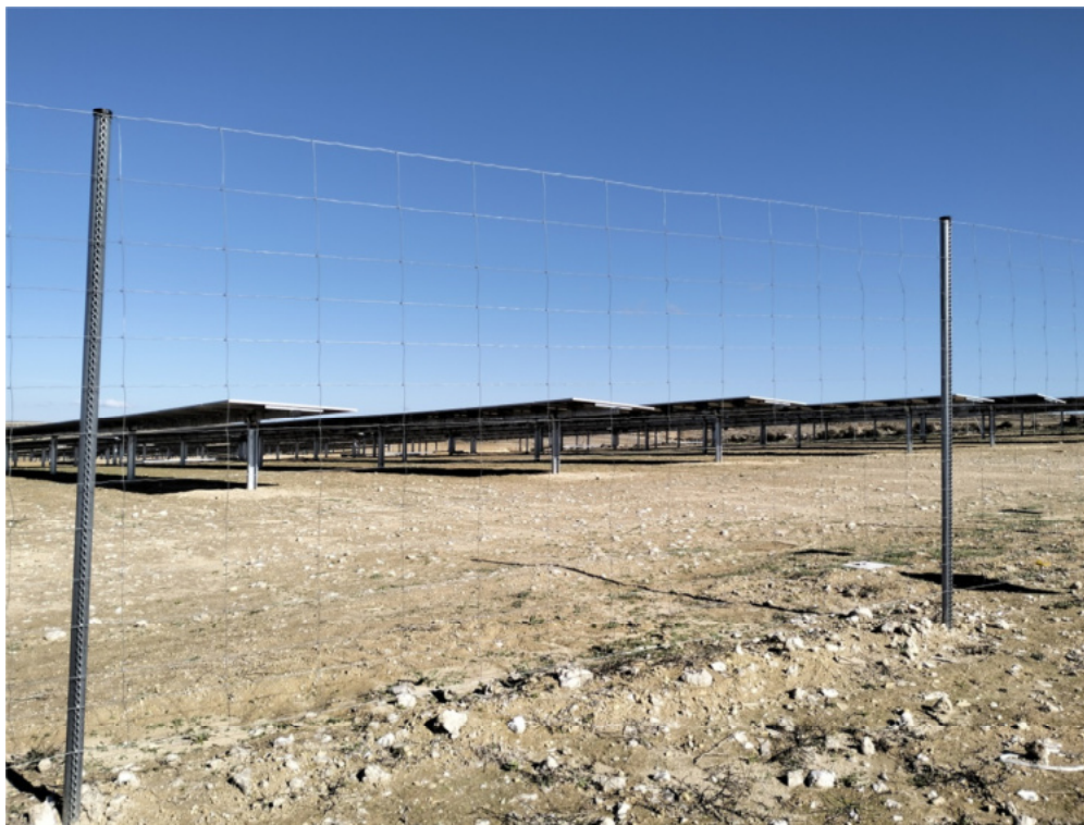
Figura 8.7. Placa ausente en el vallado de “Épila 1”
