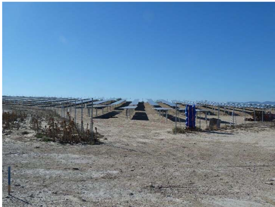
Figura 4.1. Placas solares colocadas en el recinto “Épila 2A”
