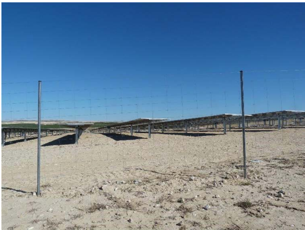
Figura 8.16. Placa ausente en el vallado de “Épila 1”
