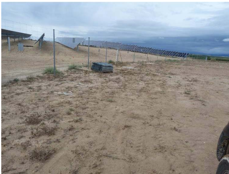
Figura 8.4. Aspecto de la planta “Épila 2A” con los paneles solares colocados
