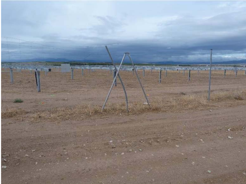
Figura 8.1. Poste doblado y vallado roto en “Épila 3”, generando elementos punzantes.
