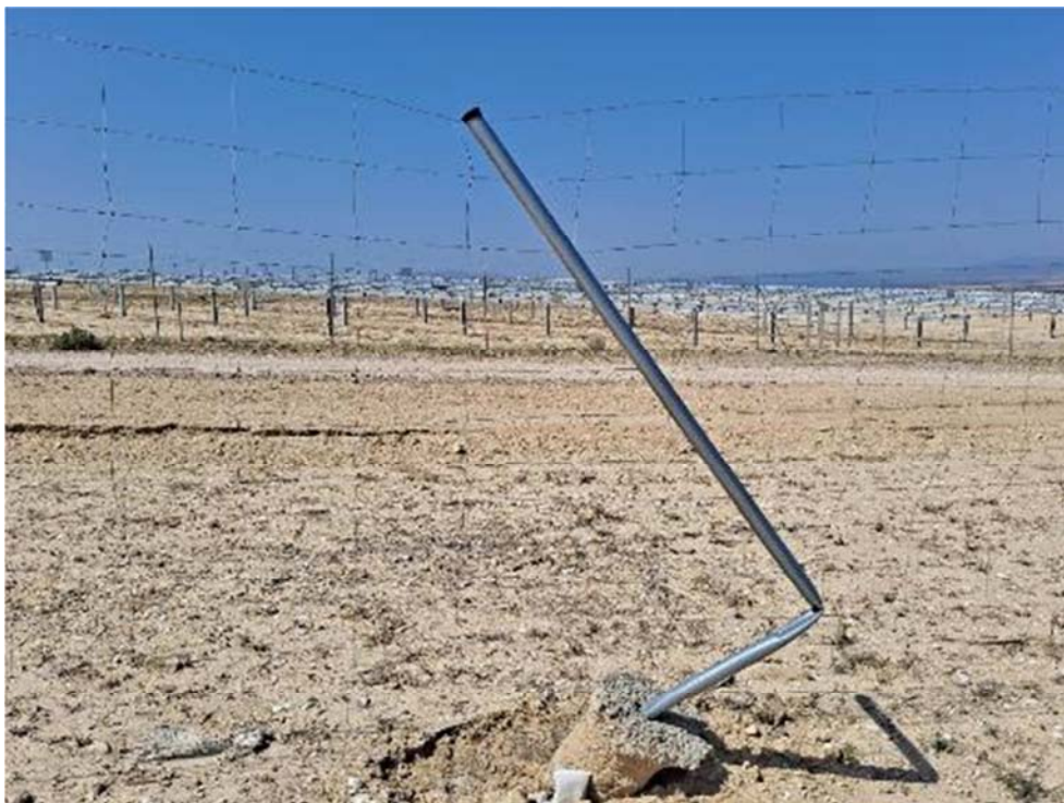
Figura 8.15. Vallado roto al doblarse el poste, dando lugar a elementos punzantes, en la planta “Épila 2B”
