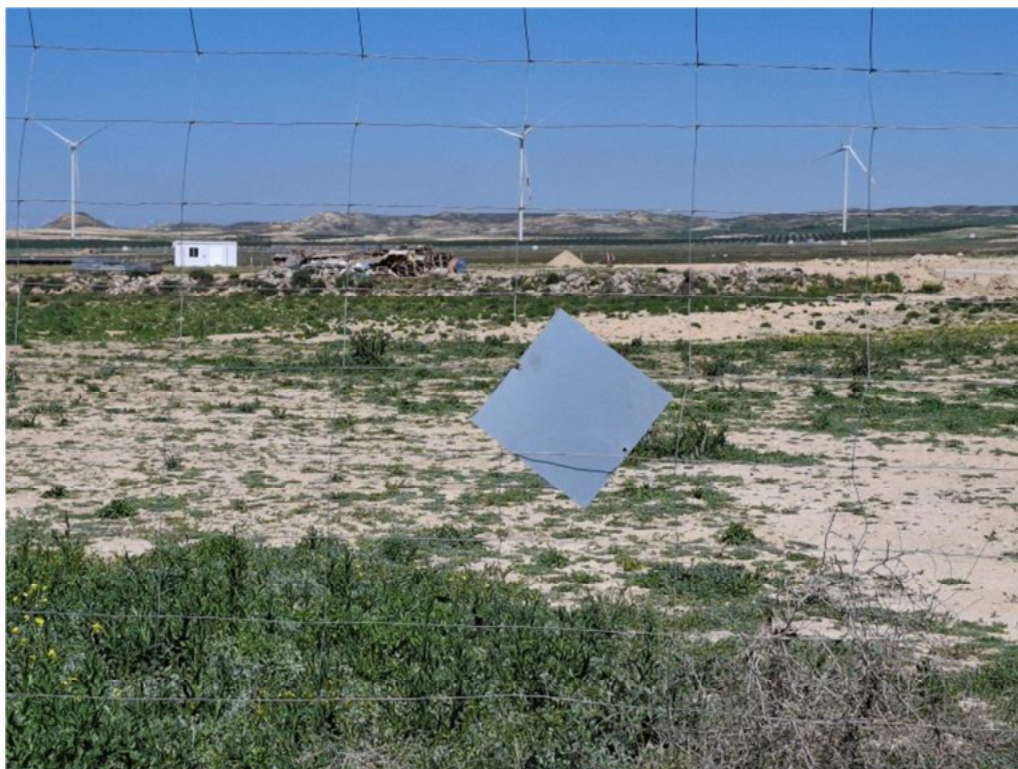
Figura 8.9. Placa con un único punto de anclaje al vallado, en la planta “Épila 2A”
