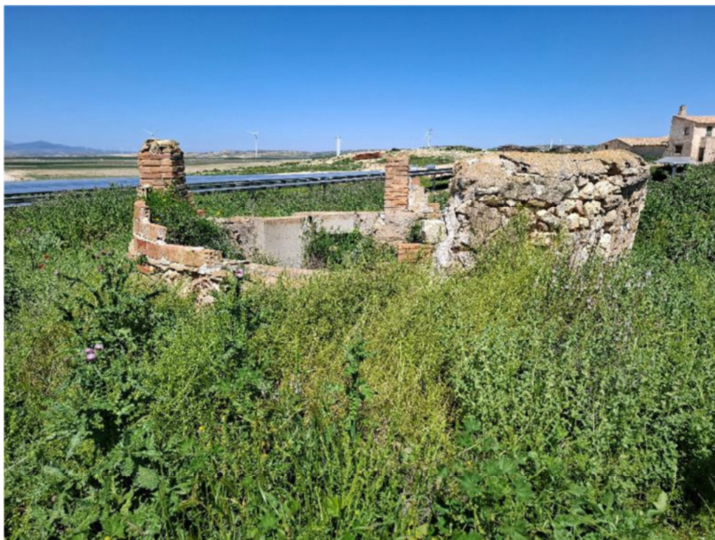
Figura 8.13. Pozo del interior de la planta “Épila 2B”, sin balizado.
