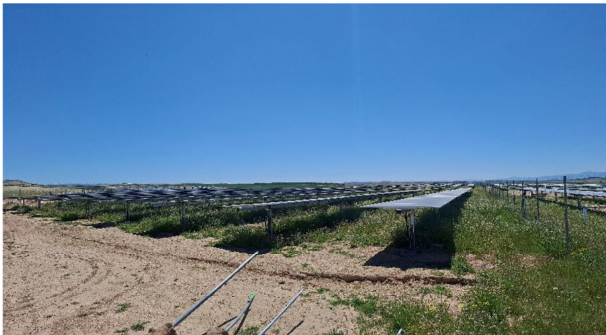
Figura 8.1. Aspecto de la planta “Épila 3”
