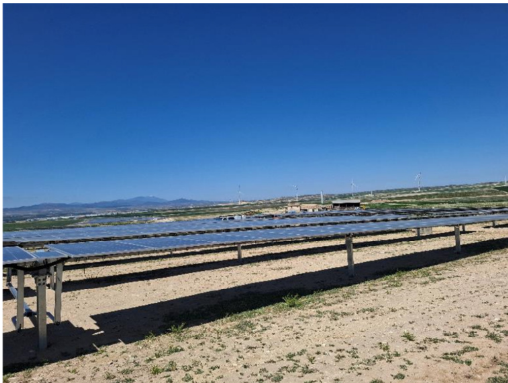
Figura 8.15. Aspecto de la planta “Épila 1”
