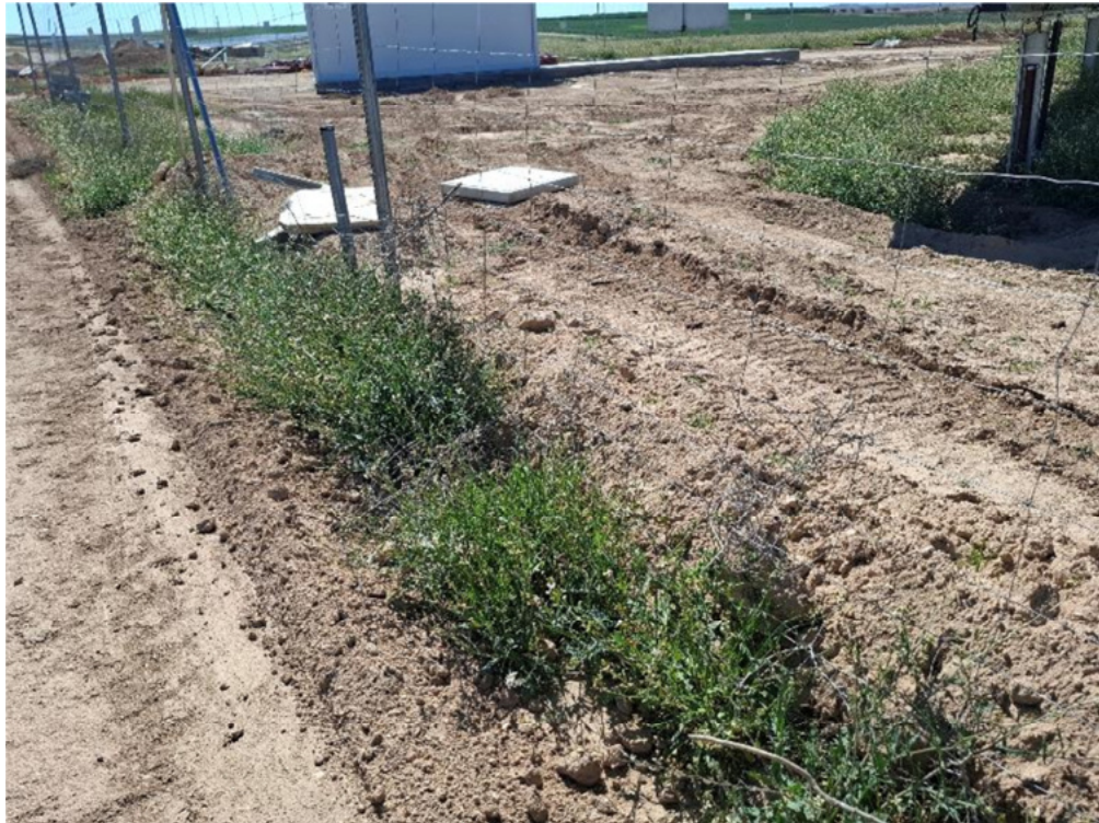
Figura 8.3. Obstrucción del paso inferior de fauna en el límite sur del vallado de "Épila 3"
