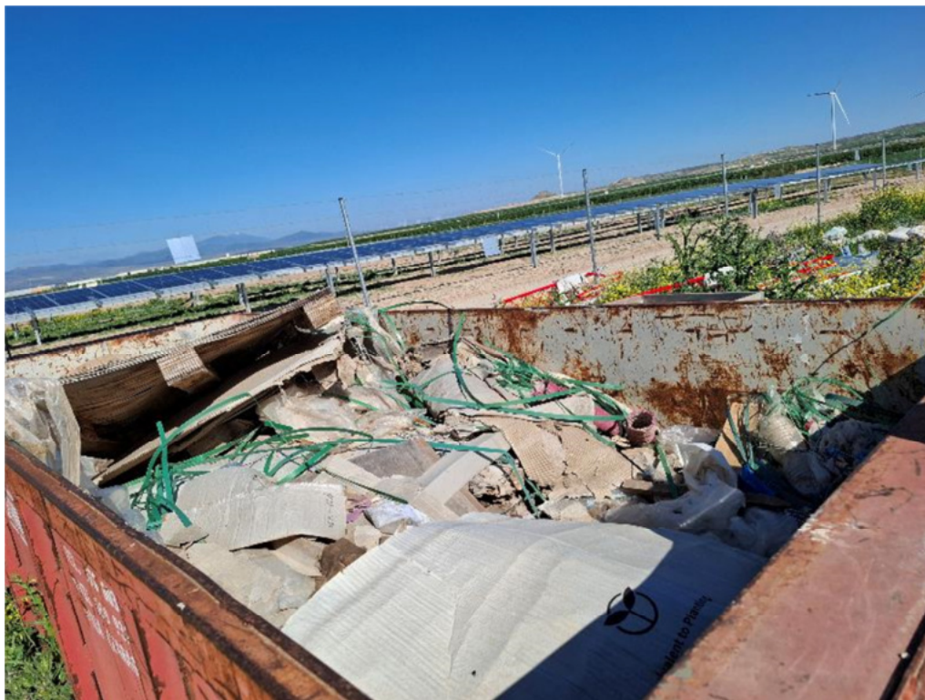
Figura 8.16. Residuos mezclados en uno de los contenedores situados entre las plantas “Épila” y “San Pedro”.
