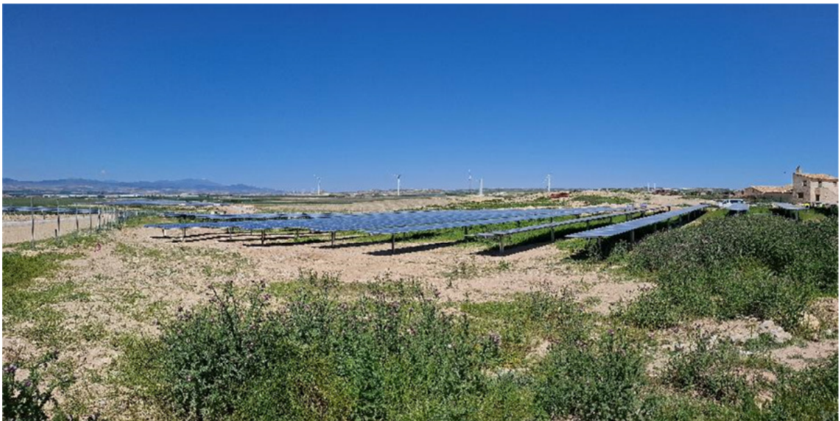
Figura 8.12. Aspecto de la planta “Épila 2B”
