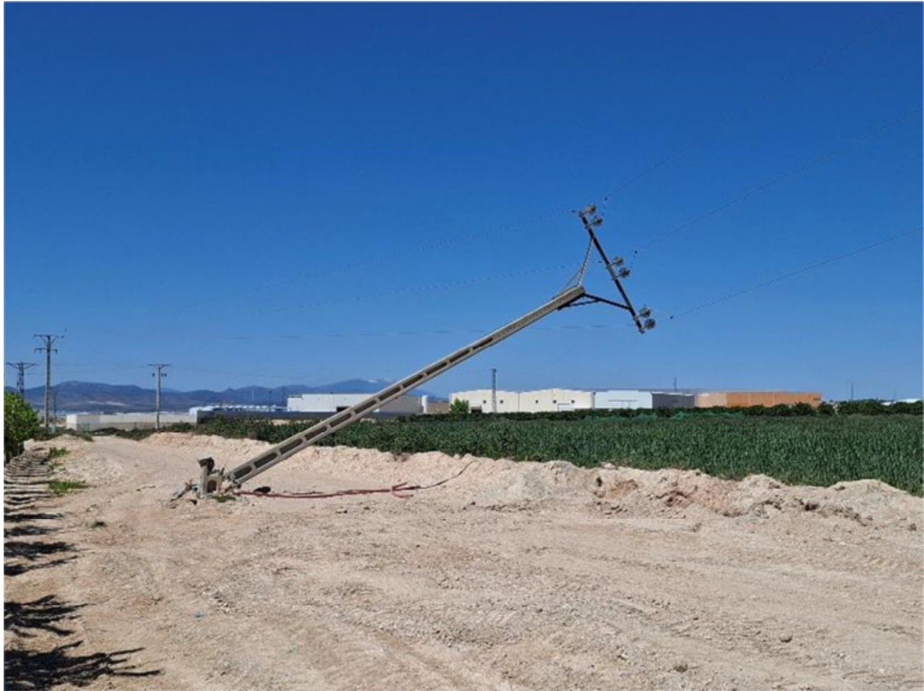
Figura 8.18. Apoyo eléctrico roto y caído sobre el camino de acceso a la planta fotovoltaica, no relacionado con las obras en "Épila 123"
