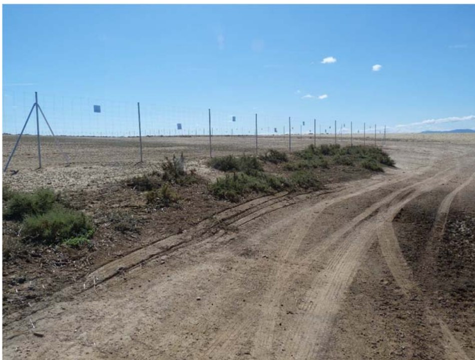
Figura 8.1. Vallado en la planta “Épila 1”, con las placas instaladas y pasos de fauna abiertos
