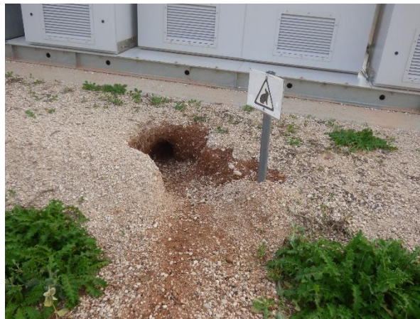
Imagen 13. Madriguera señalizada junto a un centro de transformación
