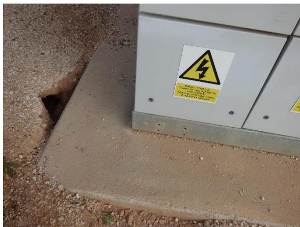
Imagen 14. Boca de madriguera junto a la losa de un centro de transformación
