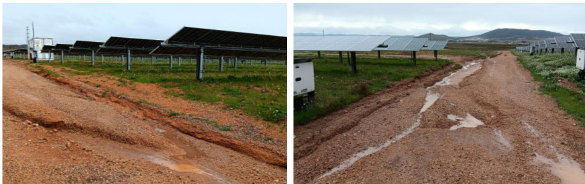
Surcos erosivos en los viales de la parcela 1 en el mes de octubre.
