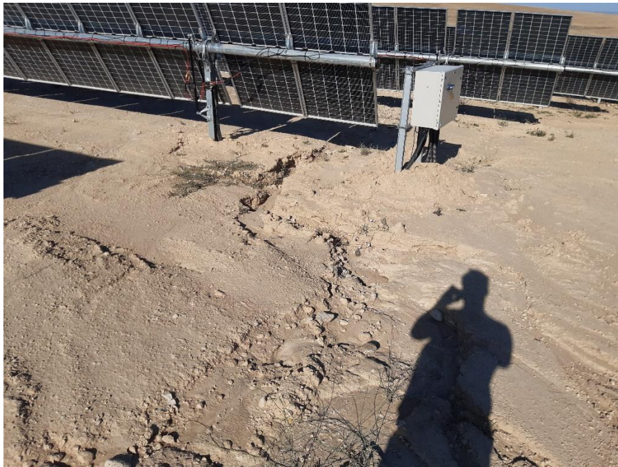
Fig. 1 Reguero observado en la visita a obra
