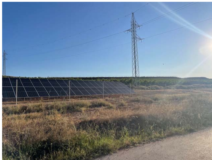
Foto 8: Instalación solar fotovoltaica desde la que se suministrará el sistema de filtrado y de re-bombeo de esta red a presión.
