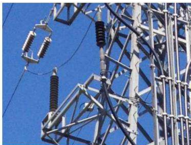
Unión conductor aéreo-pararrayos-terminal
