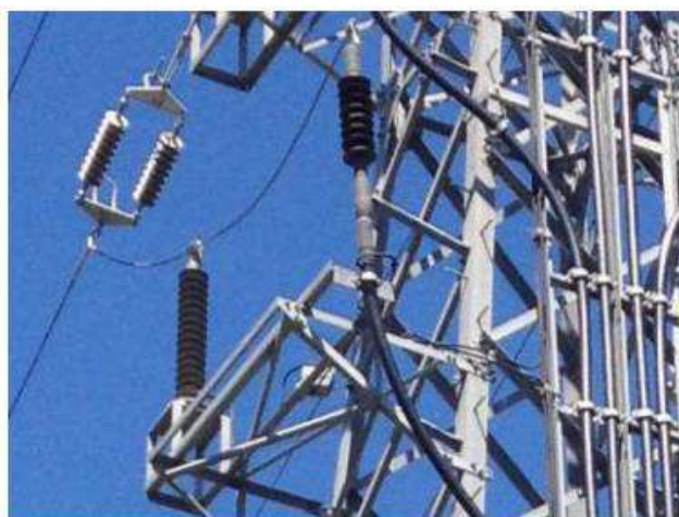
Unión conductor aéreo-pararrayos-terminal
