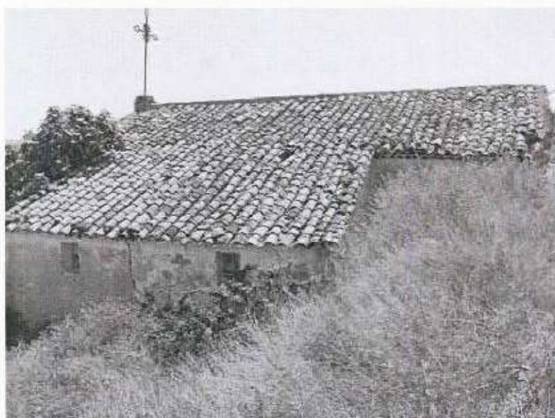
Vista parcial del estado en que se encuentra el edificio.
