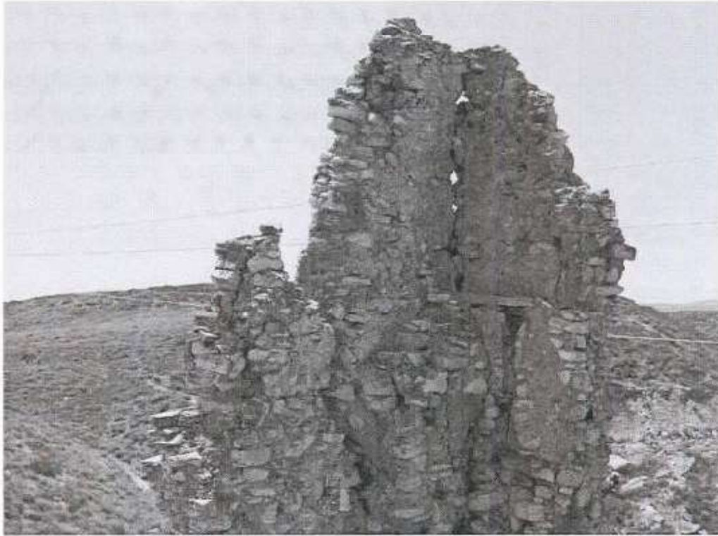
Detalle del interior agrietado del torreón sureste.
