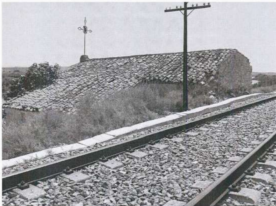
Vista del deterioro en el muro trasero de la Ermita más cercano a la vía.
