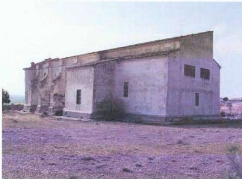
Vista de la fachada Oeste donde se aprecian diferencias constructivas
