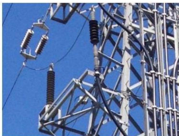
Unión conductor aéreo-pararrayos-terminal
