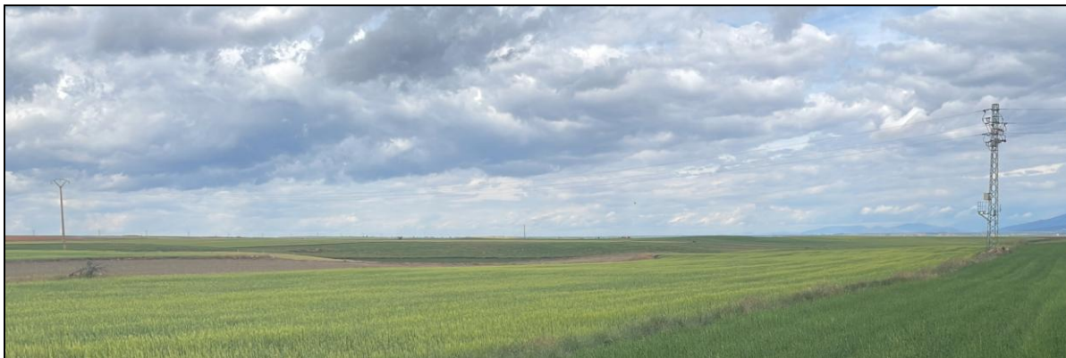
Fotografía 64. Tendido eléctrico de MT.
