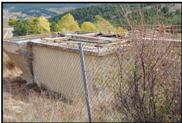
Imagen 2: Depuradora el Solano de la Vega
