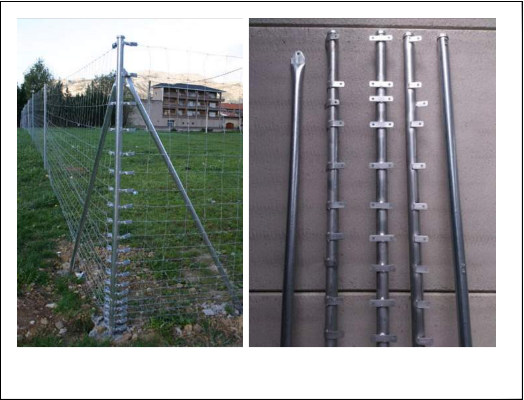
Detalle de Postes
