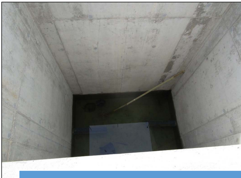
Arqueta Medida Caudal Agua Tratada
