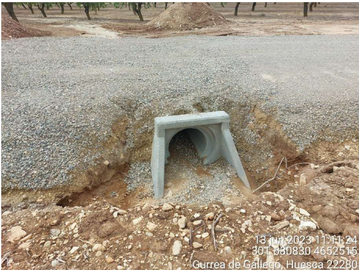
Imagen 2. Problemas de erosión y de fijación del suelo.
