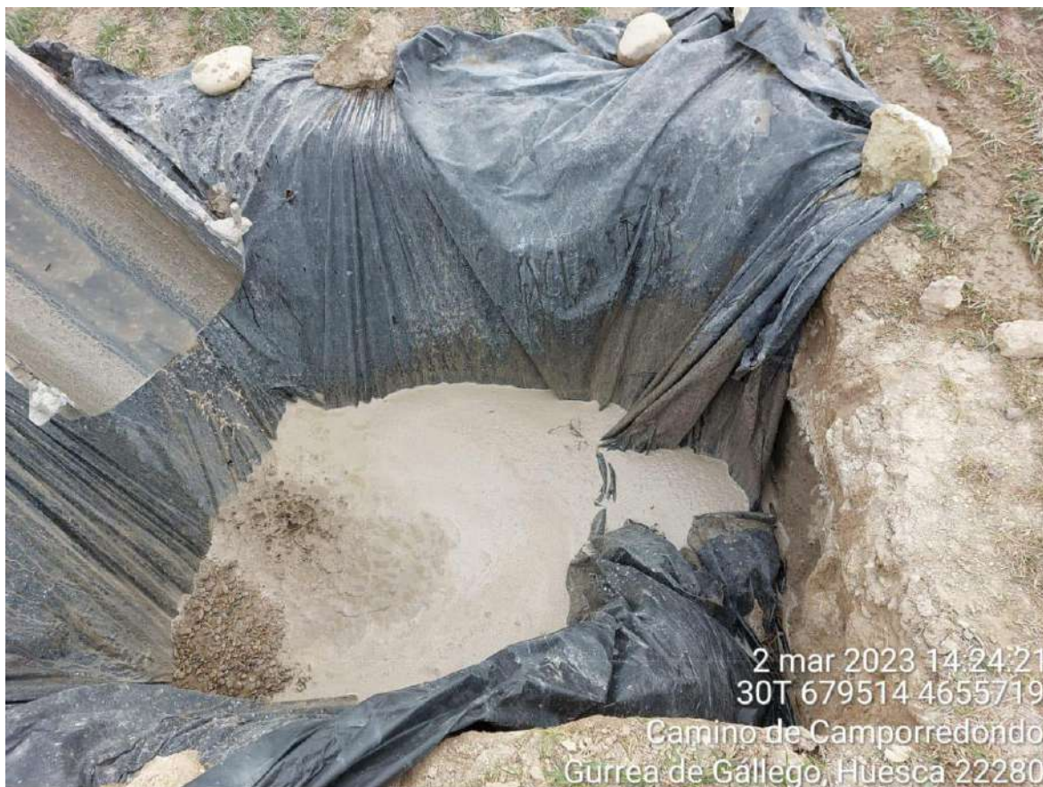
Imagen 2. Pozo de lavado en mal estado debido al levantamiento del plástico consecuencia del aire.
