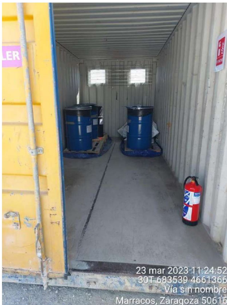
Imagen 2. Almacén de RP de Nordex en buenas condiciones.
