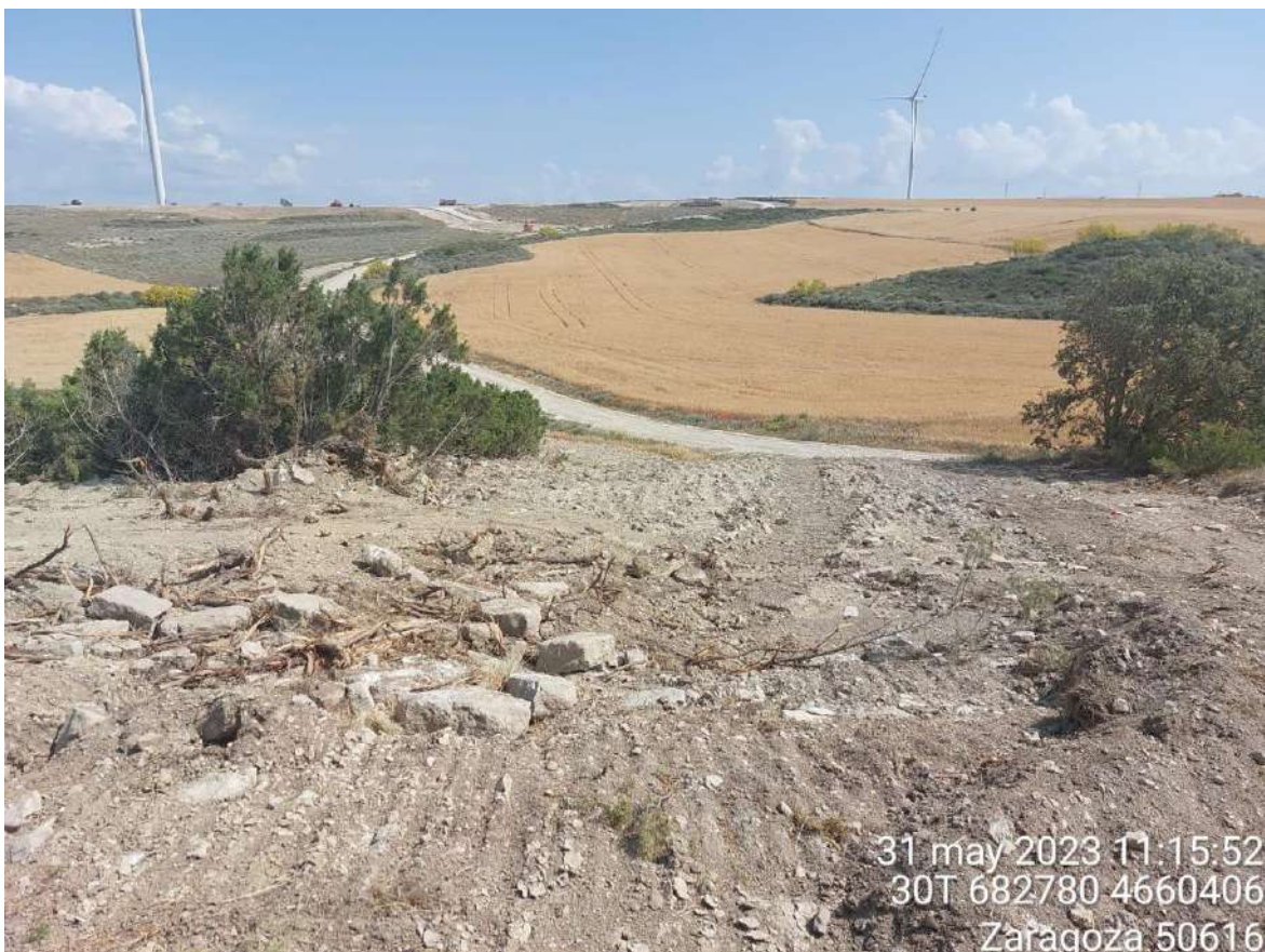
Imagen 2. Tramo de la zanja de evacuación tras relleno, pero sin restaurar definitivamente. Se deben retirar piedras y bolos de tamaño considerable.
