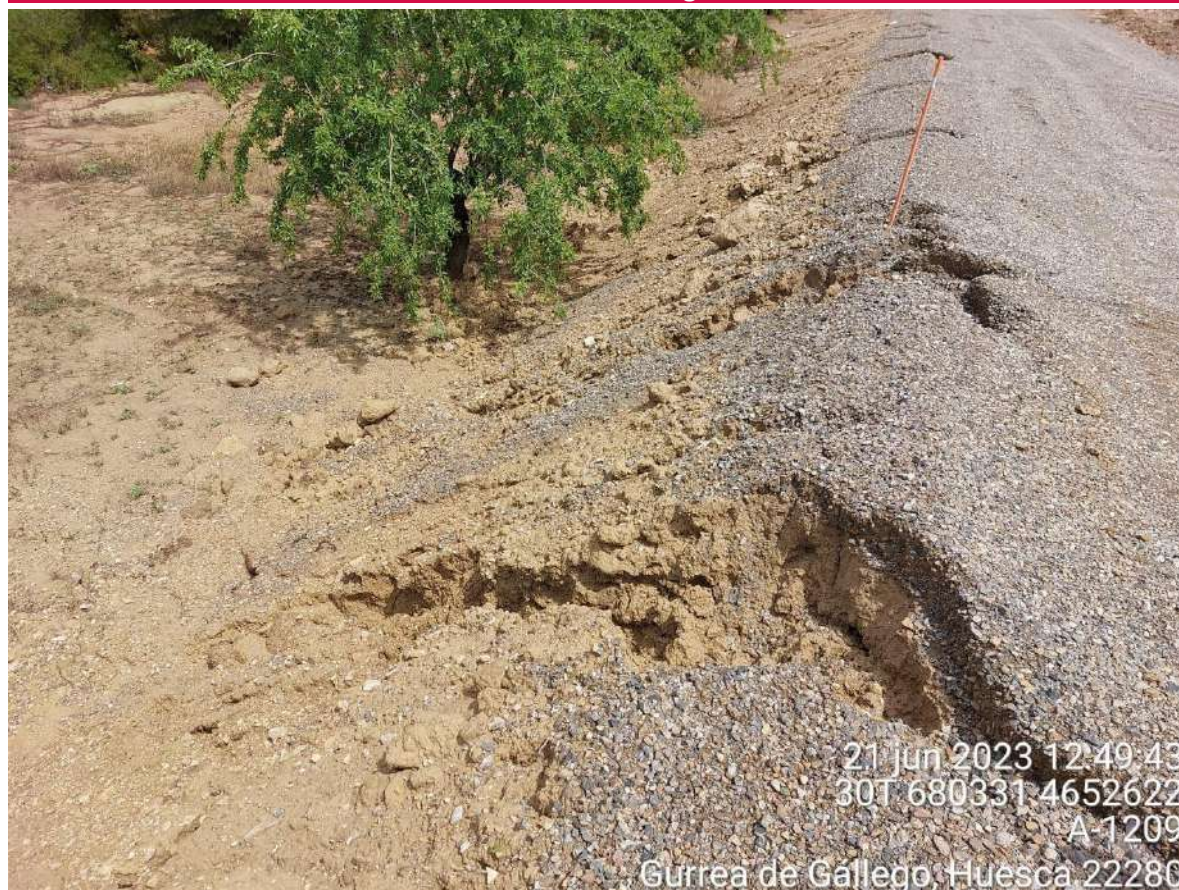
Imagen 1. Cárcavas generadas en vial de OBII debido a las lluvias caídas. Se debe volver a trabajar en estas zonas.
