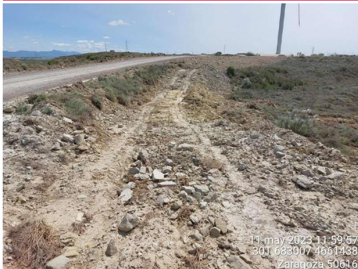
Imagen 1. Ejemplo en el que se debe incidir en la restauración con posterior hidrosiembra.
