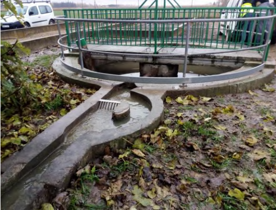
Reja de desbaste, derivación y tanque
