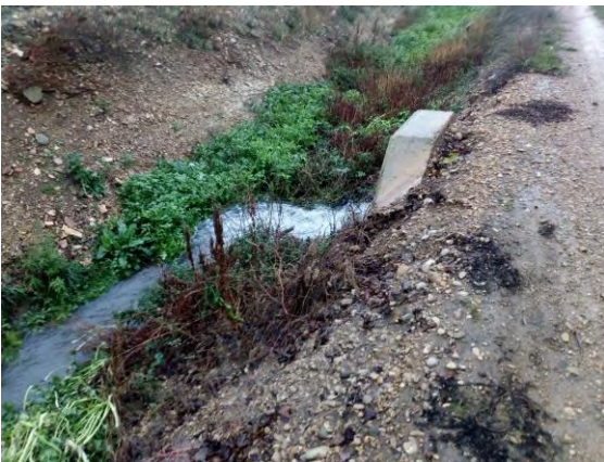
Emisario de aguas tratadas
