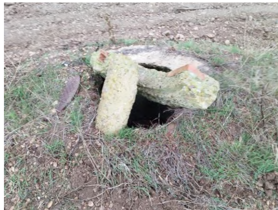
Pozo de acceso al colector en mal estado
