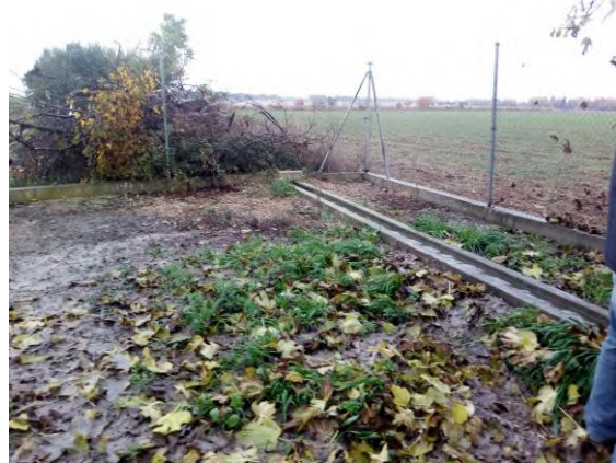
Canalillo de entrada, sufre desbordamientos
