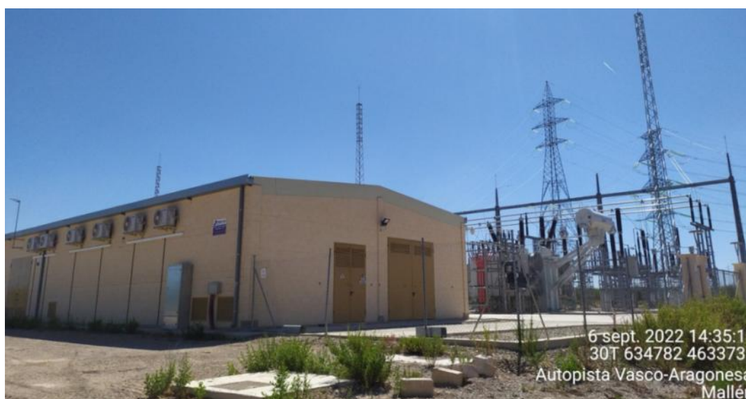
Figura 28: Subestación eléctrica Valcardera, SET asociada a PE “Multitecnología” en la que se realiza la gestión de residuos del PE, así como la ubicación del arcón refrigerador para la conservación de siniestros asociados al PE.
