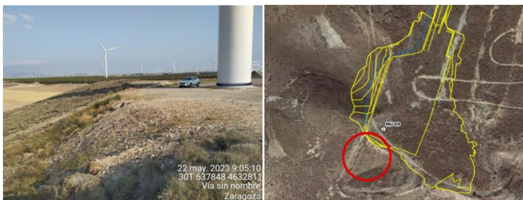
Figura 19: Fotografía y plano de localización de la erosión del talud al sur de la plataforma del aerogenerador MU-09. Pueden observarse varias cárcavas acusadas provocadas por el agua de precipitaciones torrenciales.
