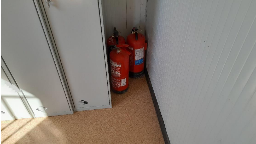
Foto 9. Medios de extinción en la zona de oficinas.
