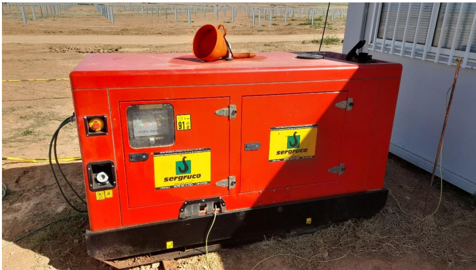
Foto 8. Grupo electrógeno en la zona de oficinas
