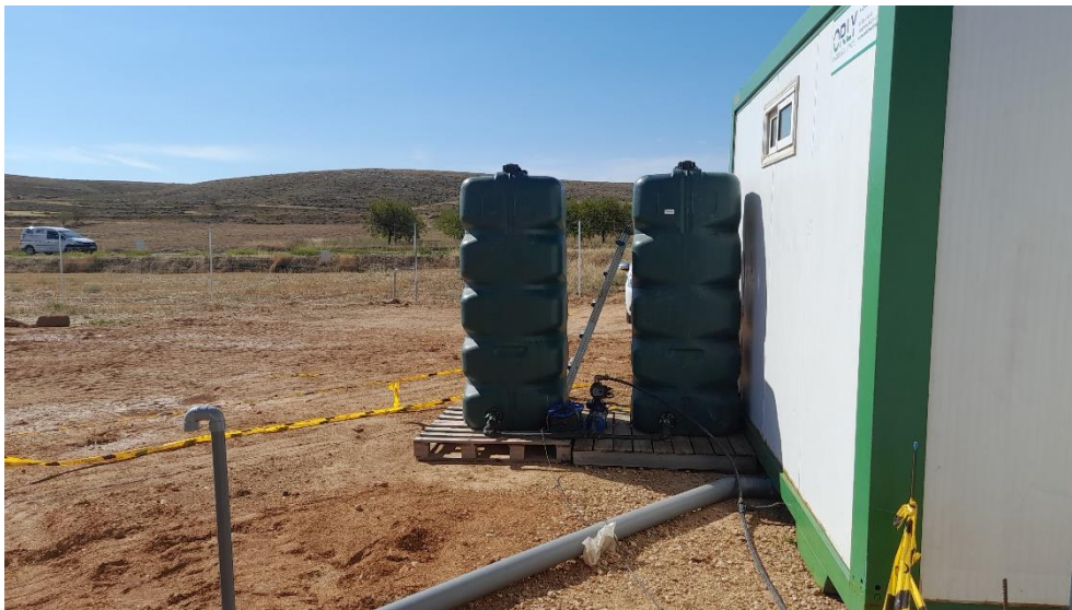
Foto 12. Depósitos de agua, conexión a fosa séptica de aseos y vestuarios fijos de nueva instalación.
