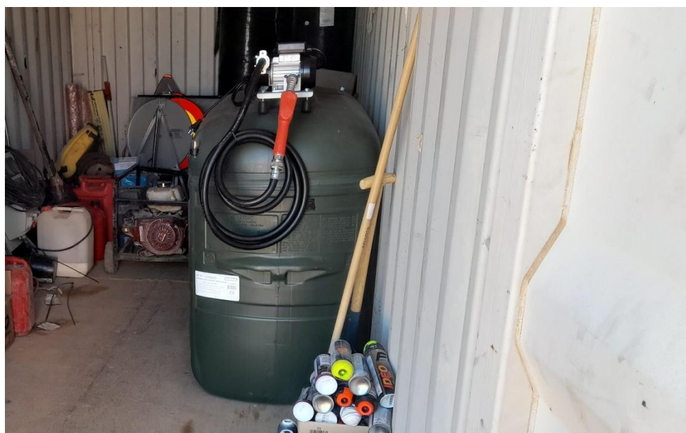
Foto 25. Depósito de abastecimiento de gasoil para grupos electrógenos
