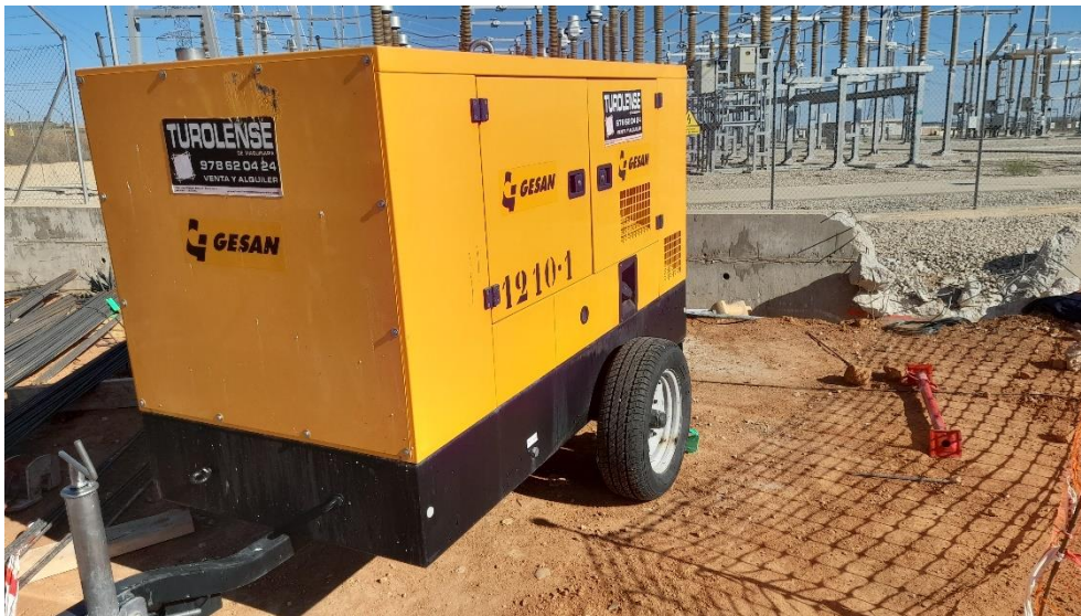
Foto 33. Grupo electrógeno en tajos
