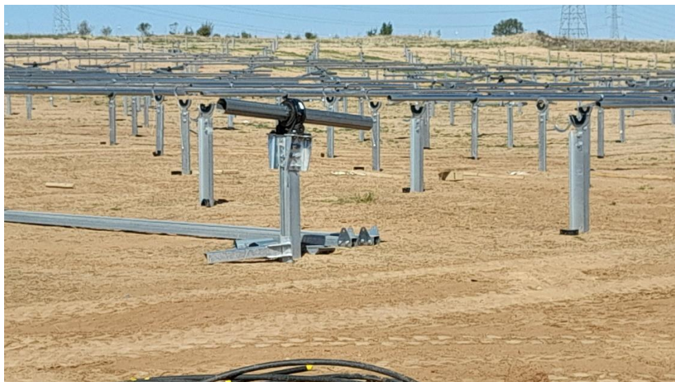
Foto 18. Vista general de estructuras de seguidores
