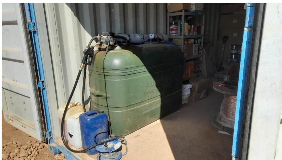
Foto 14. Depósito de abastecimiento de gasoil para grupo electrógeno
