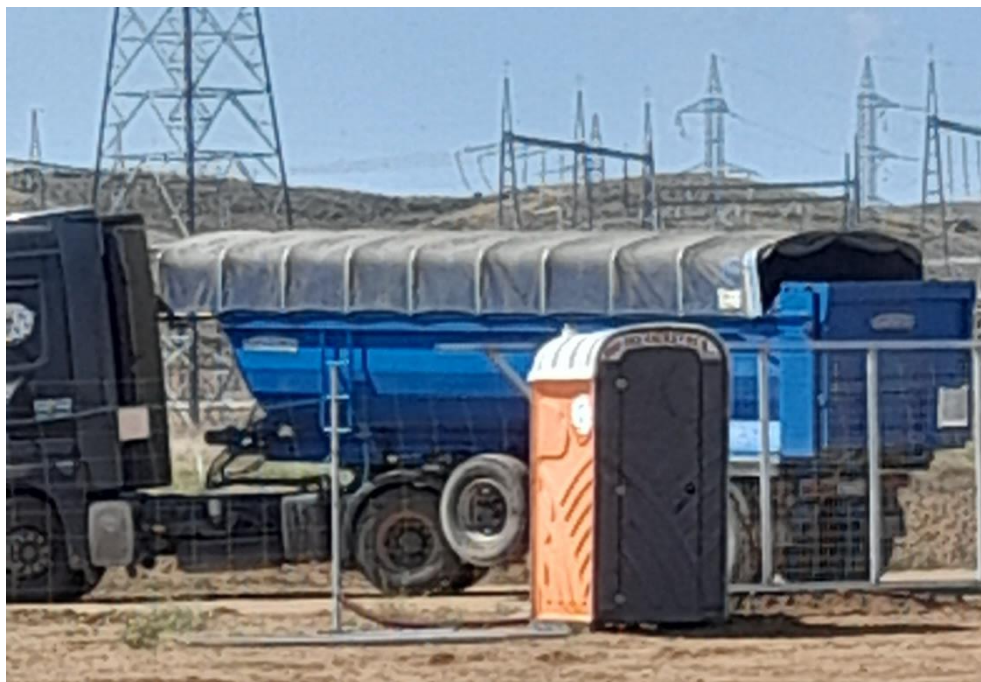
Foto 13. WC químico a la entrada de la obra.
