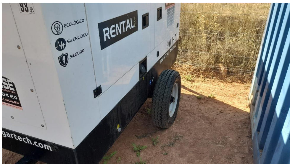
Foto 24. Grupo electrógeno en campamento de obra
