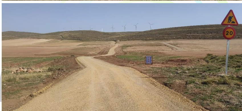
Ilustración 4. Movimiento de tierras, apertura de viales y desbroces en las poligonales 1 y 2 en las visitas 2 (arriba) y 3 (abajo).
